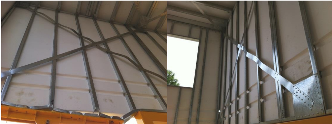
Imagen 70 e Imagen 71.- Sistema de contravientos del prototipo de vivienda. Durante el ensaye por hundimientos diferenciales se observa que la parte del contraviento a tensión toma el cortante; el brazo de compresión se pandea por su baja inercia lateral.
