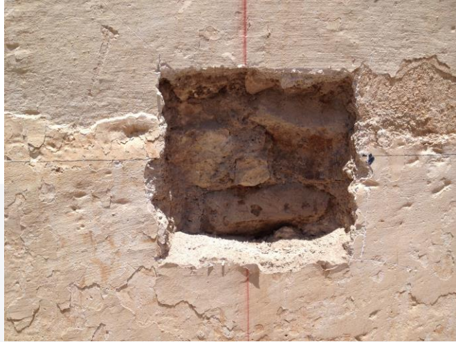
Fig.71: Retiro de capa de aplanado para descubrir material base de los muros Adobe.
