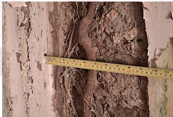
Fig.38: Fotografía de crecimiento de material orgánico vegetal al interior de los muros de la Capilla, con desprendimiento de acabado.
