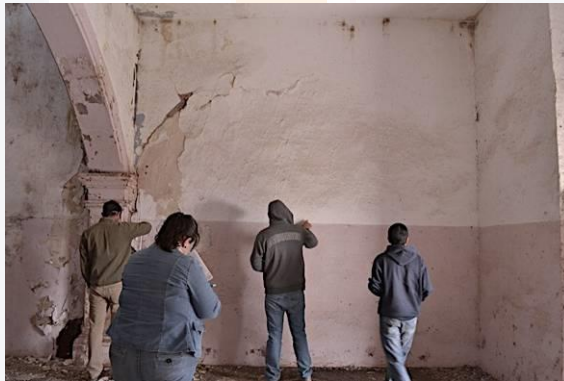
Fig.34: Inspección visual y reconocimiento de un área de la capilla para localización e identificación de patologías existentes y sus características
