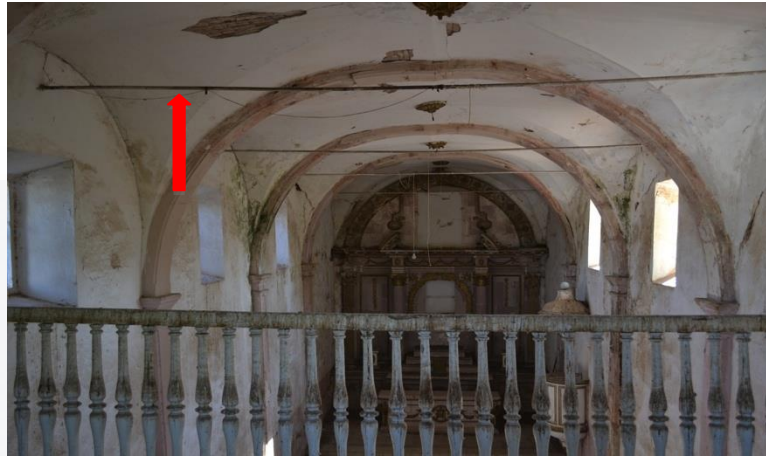
Fig.31: Ubicación de tensores interiores al centro de claros para evitar la pérdida de verticalidad de los muros. Los tensores son de tubería galvanizada lo que sugiere que su adición se realizó de una manera muy improvisada
