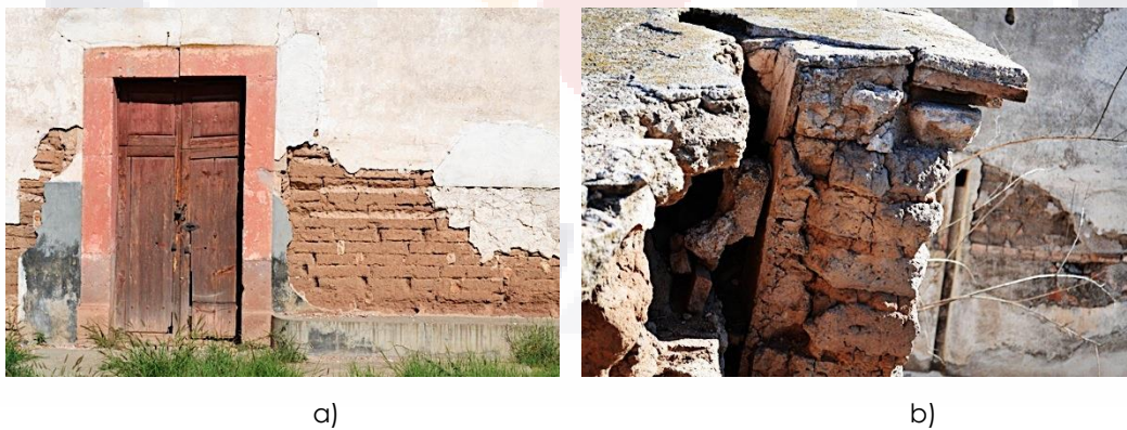
Fig.21: Muros de adobe con ausencia de aplanado y los daños que presenta actualmente a causa del intemperismo.
