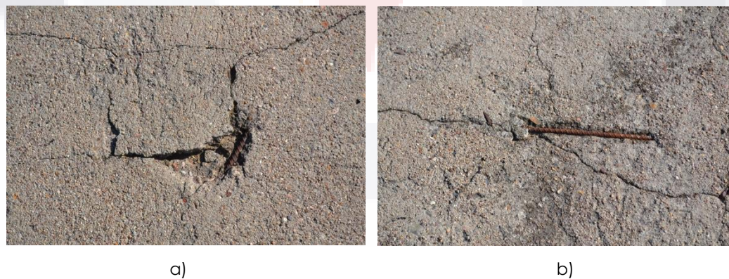
Fig.23: Acero de refuerzo expuesto en la capa de concreto de la bóveda. Se desconoce la cuantía y resistencia del acero.
