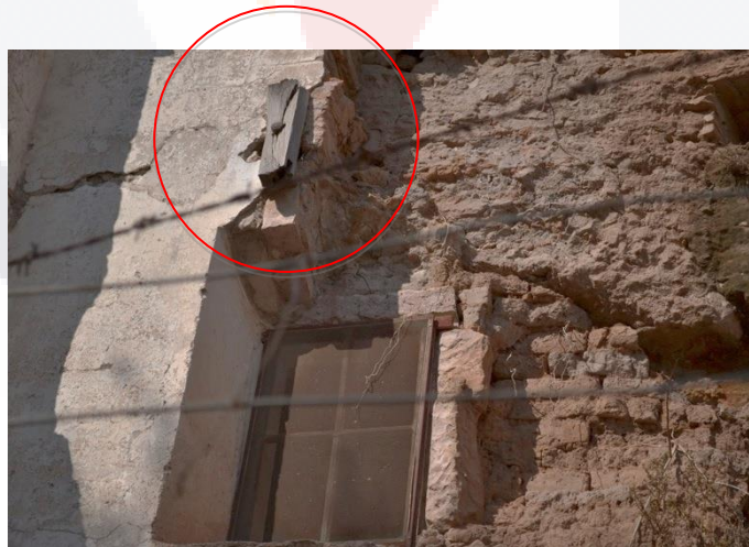
Fig.32: Detalle del anclaje exterior de los tensores . Se utilizó madera que en la actualidad se encuentra muy deteriorada
