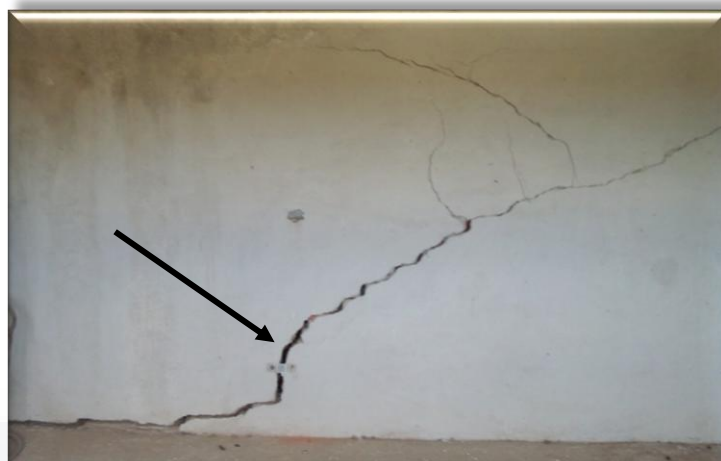
Figura 50. Muro 30 de planta alta
