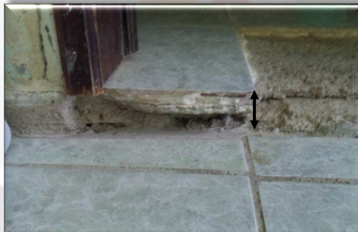
Figura 49. Muro 20 de planta baja. Desplazamiento vertical inicial
