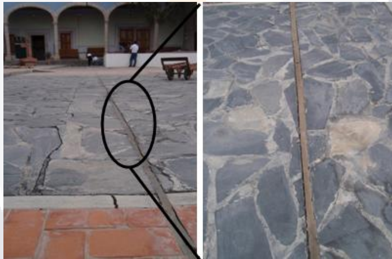
Figura 37. Junta fría (viendo hacia arco sur).
