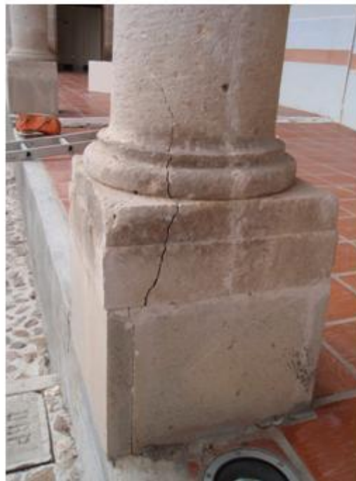
Figura 92 Columna de arco norte con fisura. Foto tomada a finales de esta investigación (agosto 2013)
