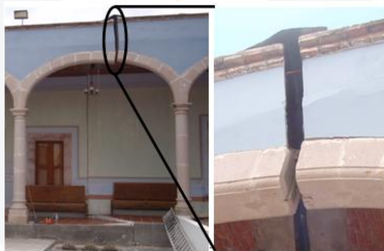
Figura 25. Junta fría en arco sur.
