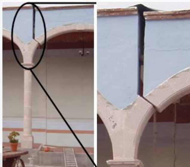
Figura 19. Junta fría en arco norte debido a la falla.
