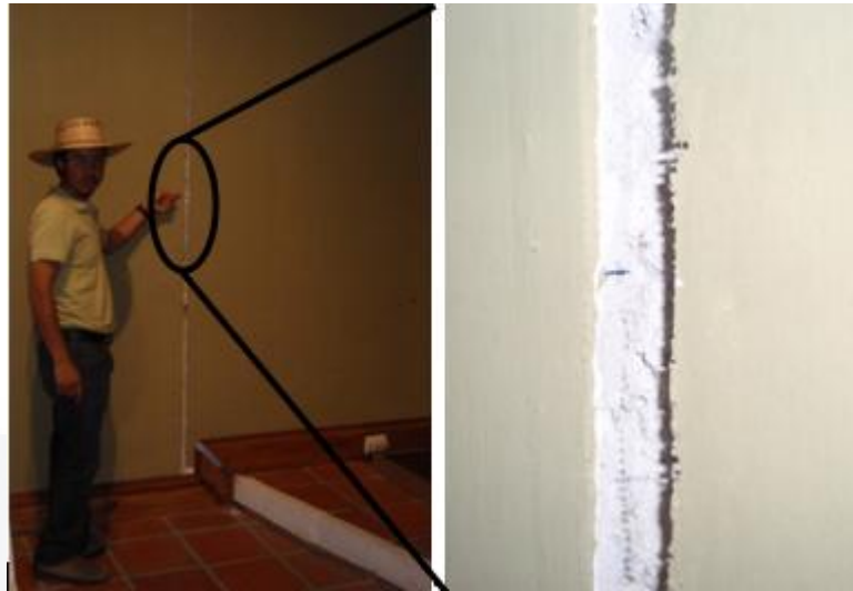
Figura 31. Junta fría en muro sur de la sala de exhibición, desprendimiento de plafón.
