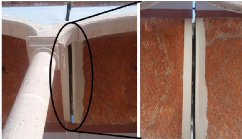
Figura 20. Vista inferior de bóveda de arcos norte. Junta fría.
