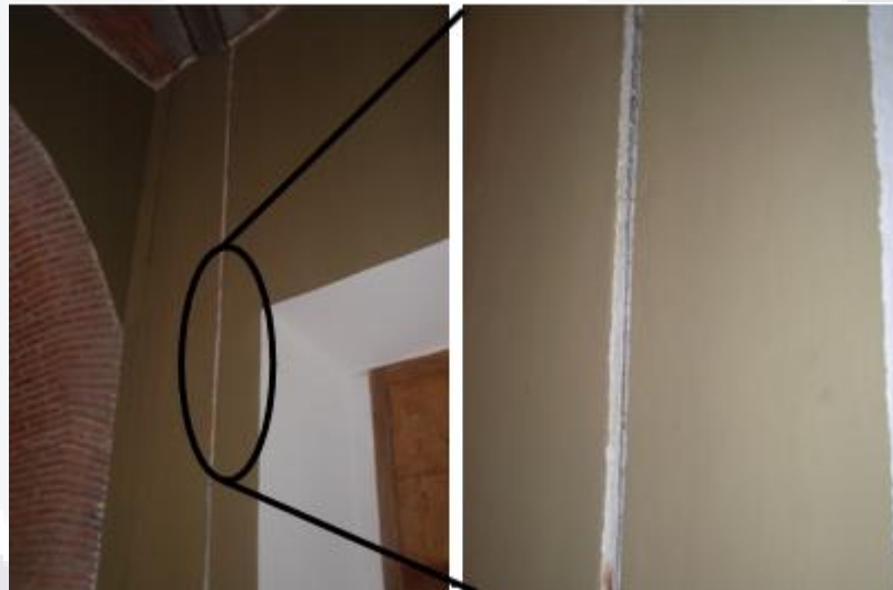
Figura 30. Junta fría en muro norte de la sala de exhibición, desprendimiento de plafón.
