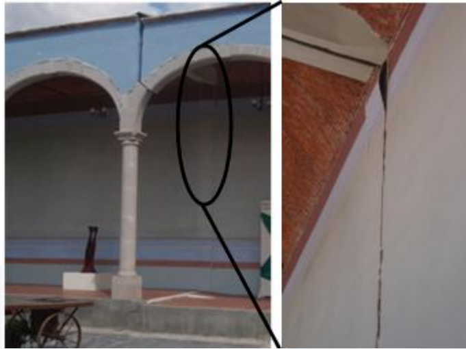
Figura 18. Junta fría en muro norte, desprendimiento del plafón.
