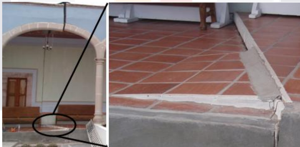
Figura 34. Simulación de escalón por cambio a desnivel provocado por la falla en arco sur.
