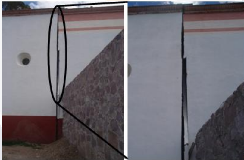
Figura 32. Junta fría en muro sur de la sala de exhibición, en exterior del Museo.
