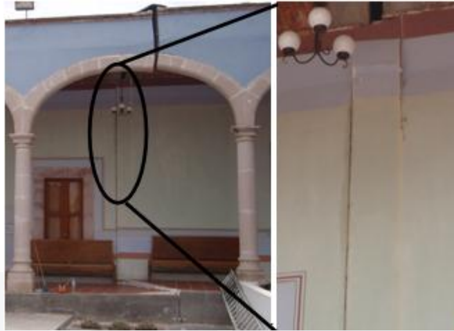
Figura 24. Junta fría en muro de pasillo sur, desprendimiento de plafón.
