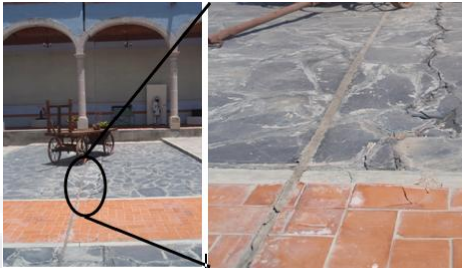
Figura 36. Junta fría (viendo hacia arco norte).
