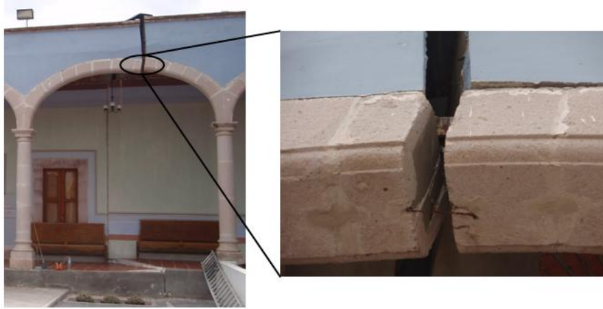
Figura 73. Junta fría en el arco sur.
