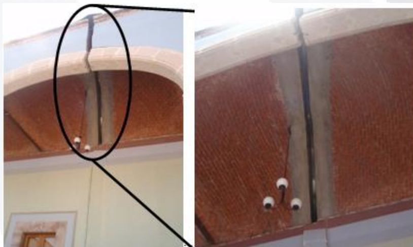
Figura 23. Junta fría en bóveda en pasillo sur.
