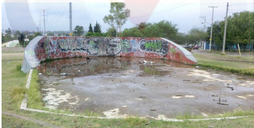
Gráfico 48. Ejemplo del deterioro de los juegos en las áreas de equipamiento urbano, Fraccionamiento Municipio Libre
