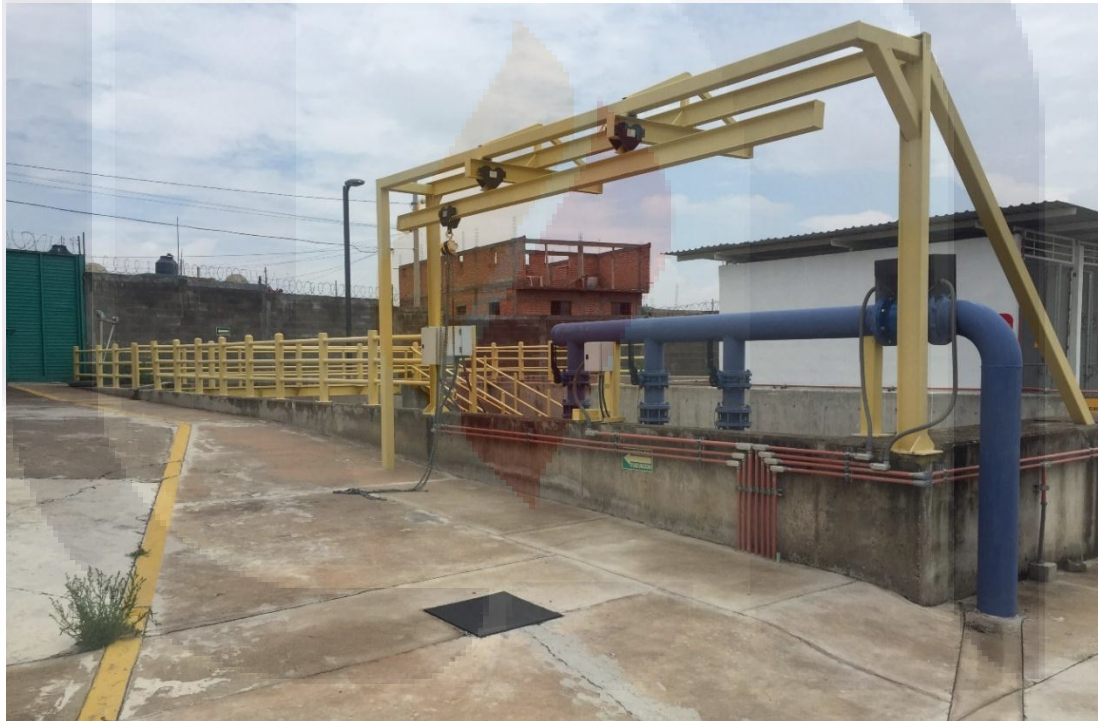
Ilustración 4 Planta de tratamiento Miradores en Aguascalientes.
