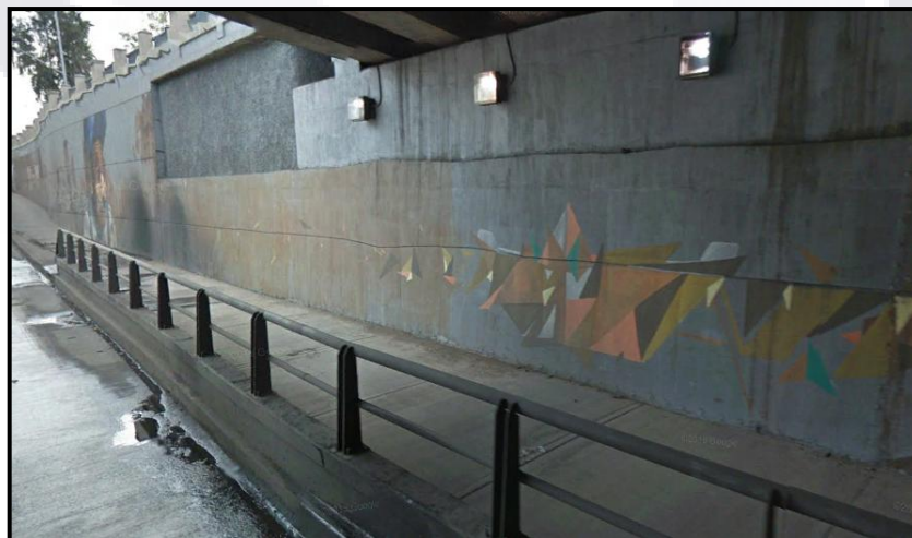
Figura 28. Infiltraciones en el paso vehicular inferior en el cruce de Av. Alameda y las vías del ferrocarril
