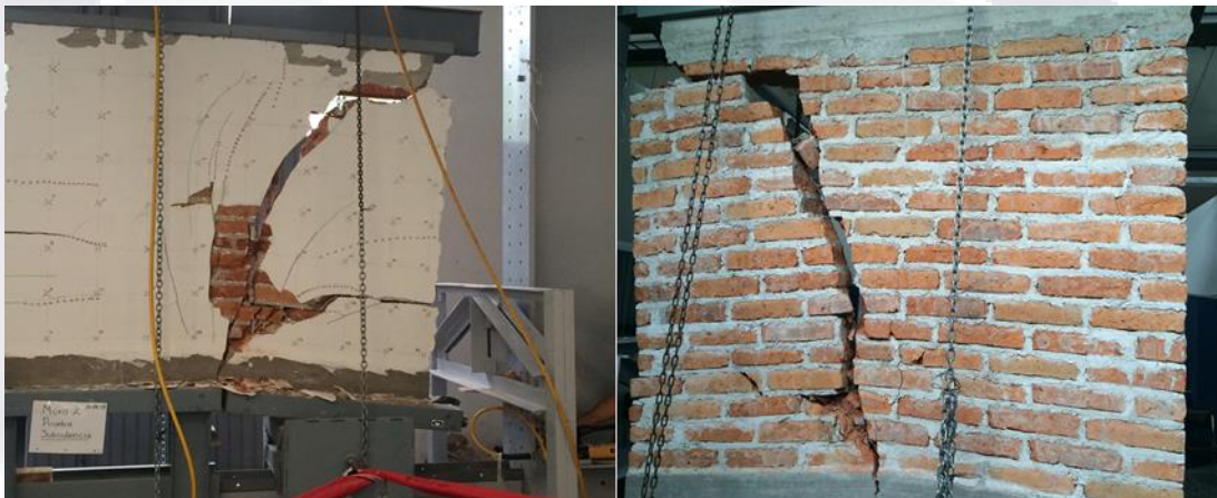
Figura 74 Fallo del muro por tensión diagonal en los tabiques.
