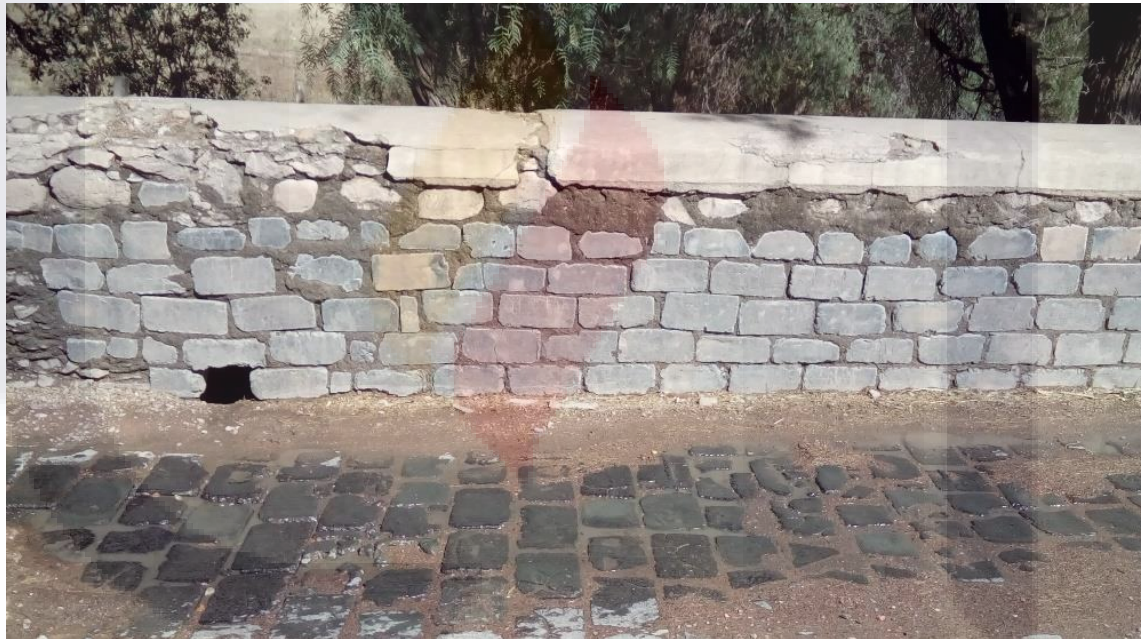
Imagen 18. Parapeto aguas arriba, con recubrimiento de piedra grasa y concreto superior deteriorado. Fuente propia.
