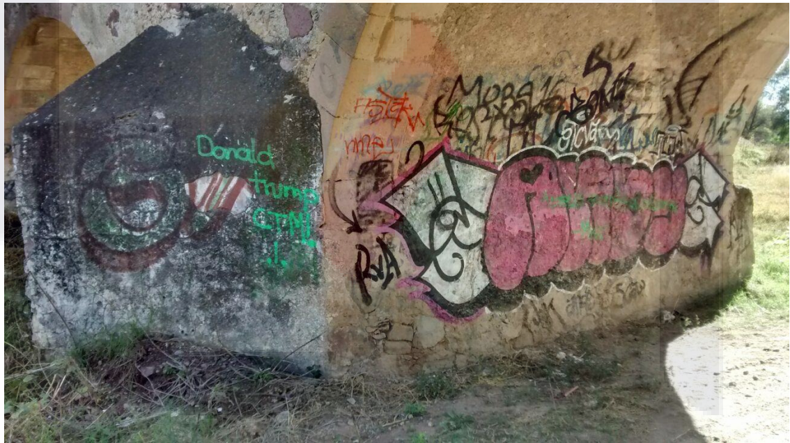
Imagen 25. Grafiti sobre arcos de piedra en el puente. Fuente propia.
