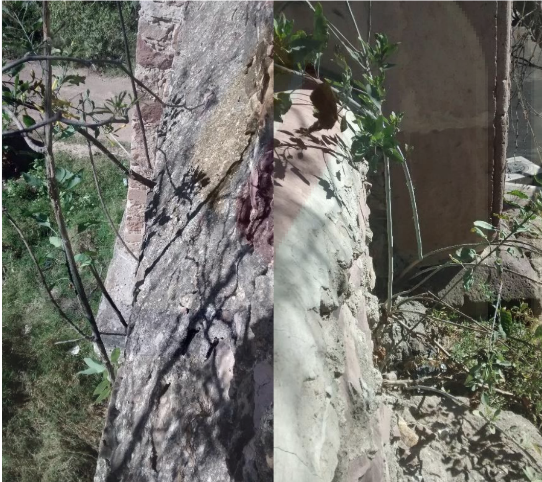
Imagen 27. Vegetación invasiva: figura a ramas y vegetación crecienta en el exterior del puente y figura vegetación crecienta junto a pilar de acceso. Fuente propia.
