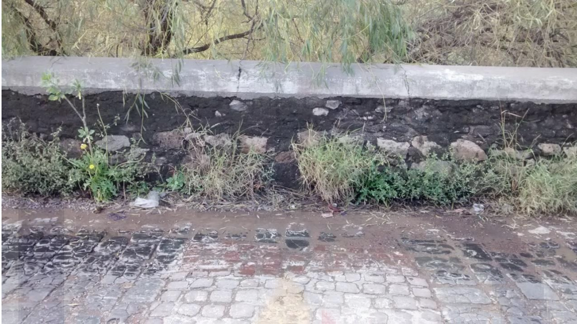
Imagen 28. Vegetación creciente al interior del puente. Fuente propia.
