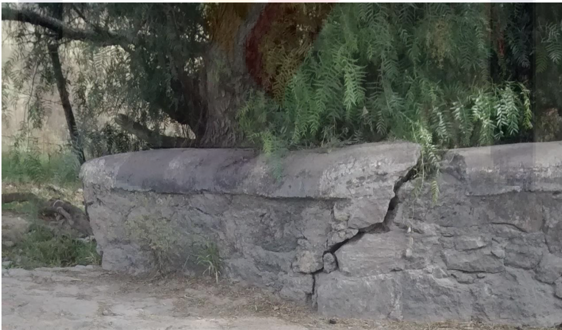
Imagen 29. Árbol pegado al parapeto del puente de San Ignacio, lado poniente. Fuente propia.
