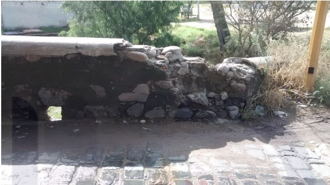
Imagen 19. Parapeto dañado aguas abajo y con piezas faltantes. Fuente propia.
