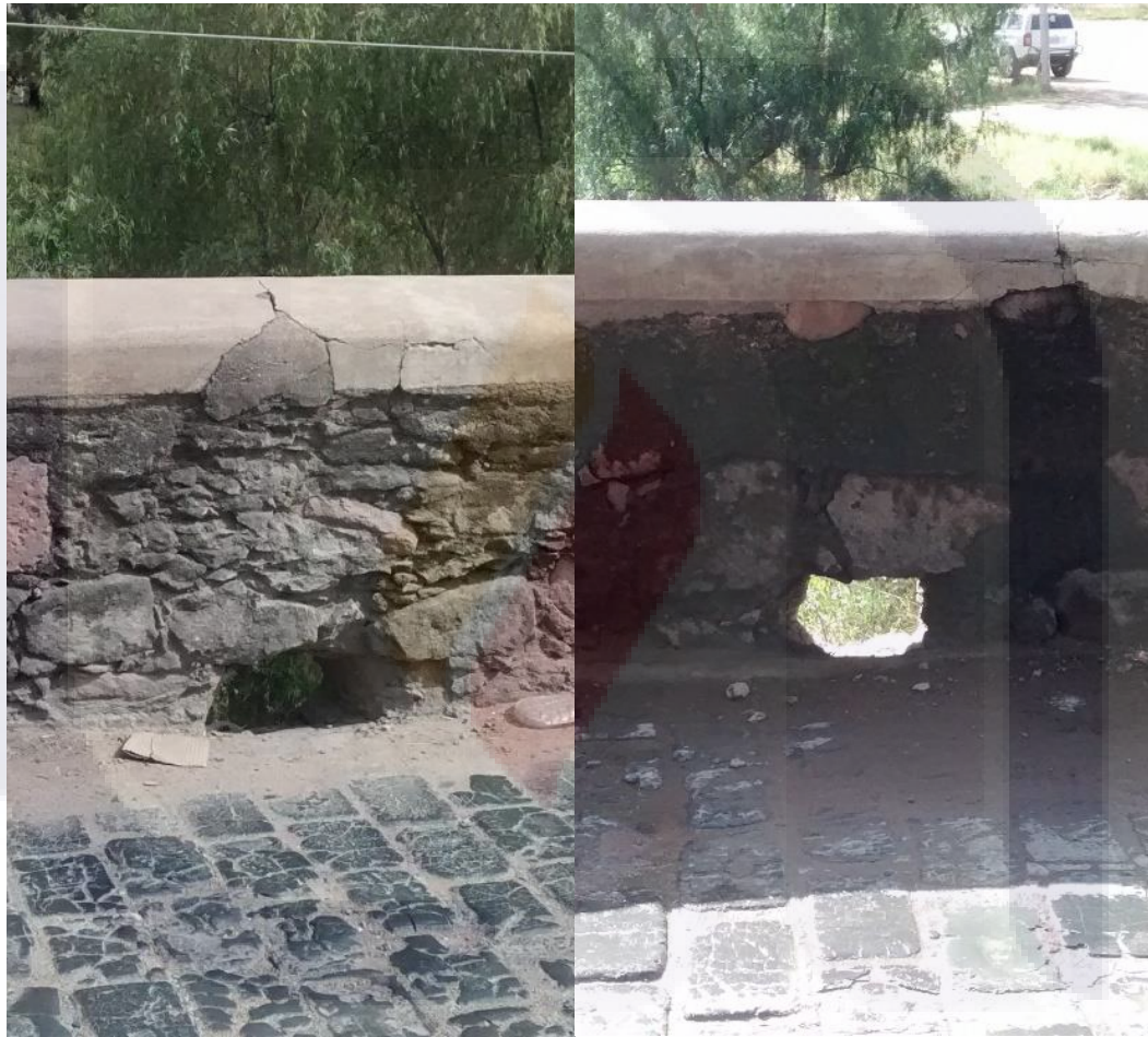
Imagen 17. Vanos: figuras a y b, drenes hechizos y en mal estado en el puente lado aguas abajo. Fuente propia.
