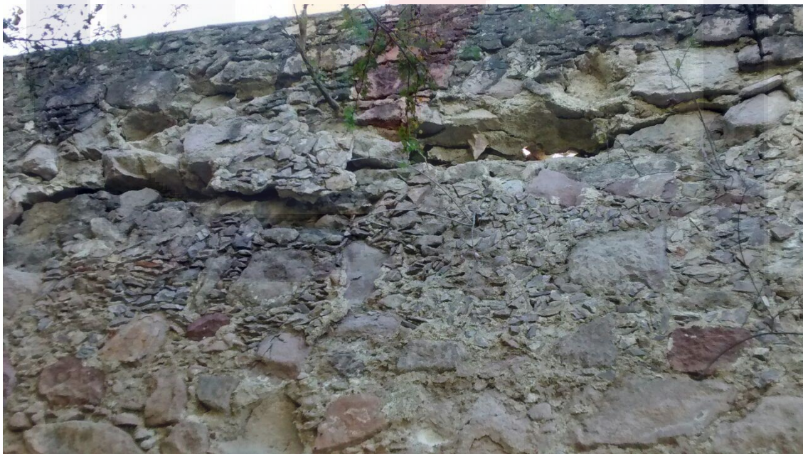
Imagen 20. Fragmento suelto del parapeto.
