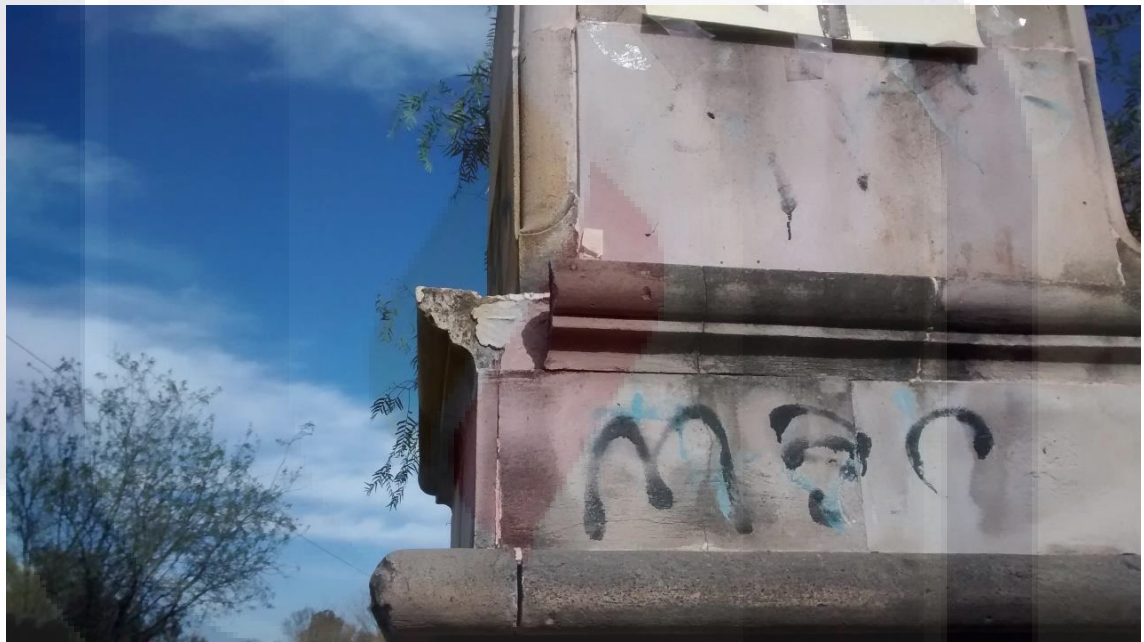
Imagen 22. Pilar del Puente con suciedades; la suciedad se observa en tono más oscuro. Fuente propia.
