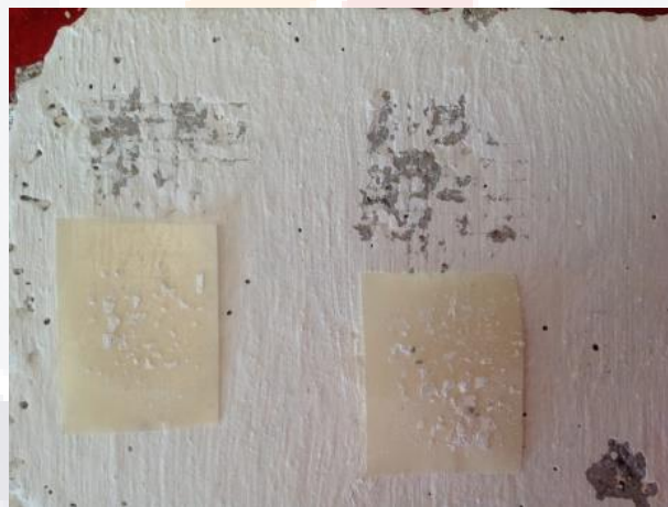
Figura 4.84 Desprendimiento de la película aplicada en el panel de block por PFN.
