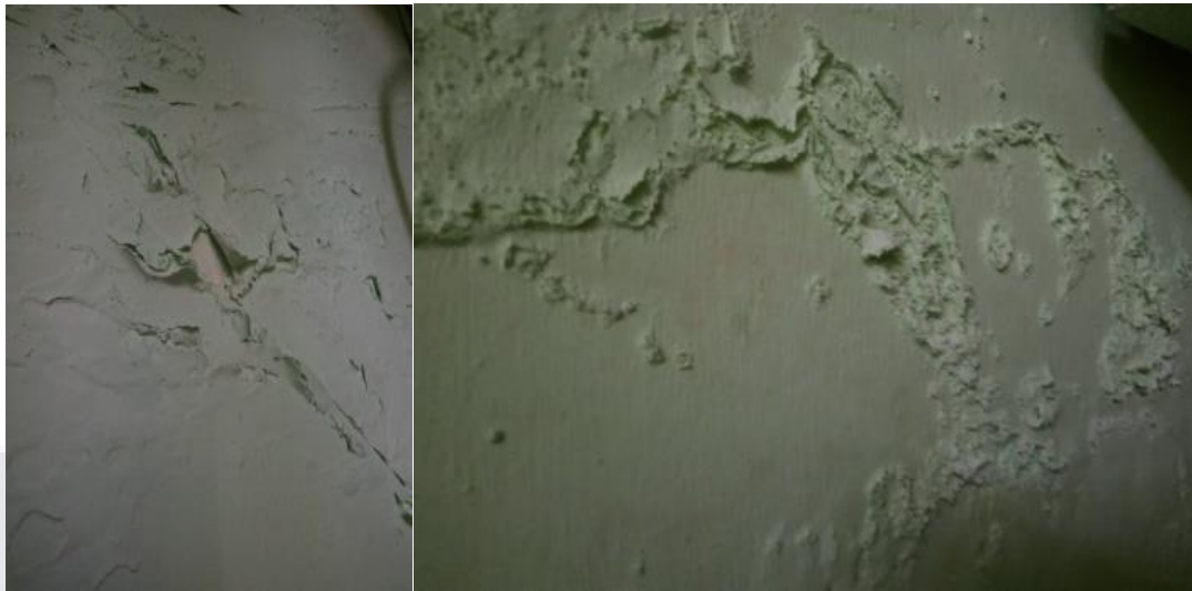
Figura 2. 4 Ejemplo de desprendimiento en casa habitación, Aguascalientes.
