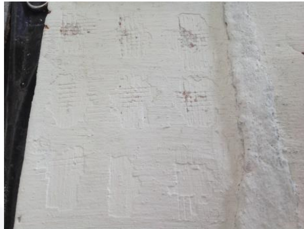
Figura 4.122 Clasificación 5B (0% de remoción) en el panel de tabique con el recubrimiento de PFN1.
