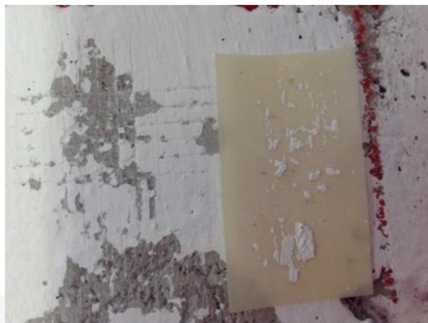
Figura 6. 18 Desprendimiento de la pintura PFN en el área de corte.
