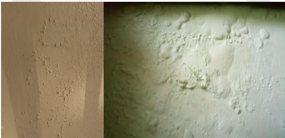
Figura 2. 5 Presencia de ampollas en muro de casa habitación, Aguascalientes.
