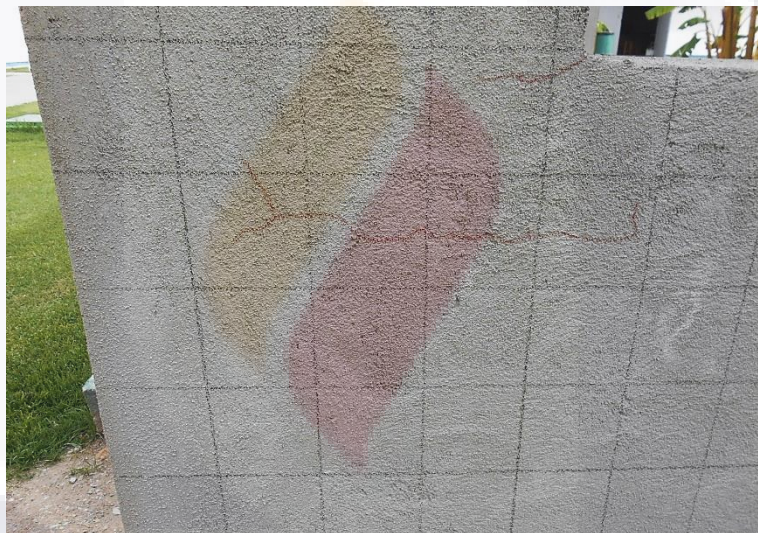
Imagen 45 Registro de fisuras con lápiz de cera en MTR 2-B-MCEM.
