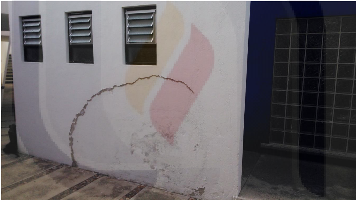
Imagen 8 Lesiones en paramento causadas por eflorescencias y criptoeflorescencias
