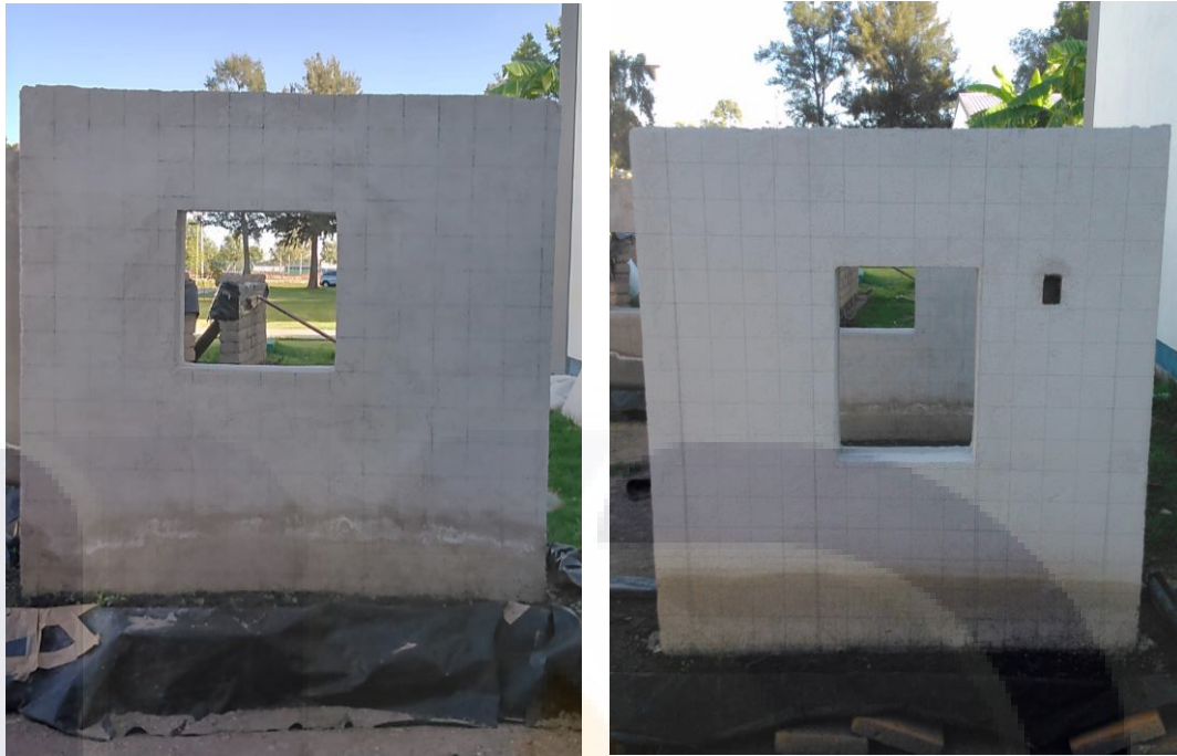
Imagen 53 Eflorescencias producidas por presencia de humedad en aplanados de muretes de prueba MTR 1-B-MCCA (Izq.) y MBC 2-B-MCAL (Der.).
