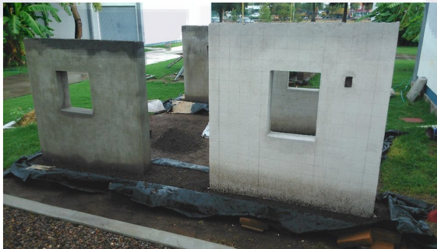
Imagen 51 Presencia de humedad en aplanados por lluvia y por mecanismo de retención de agua.
