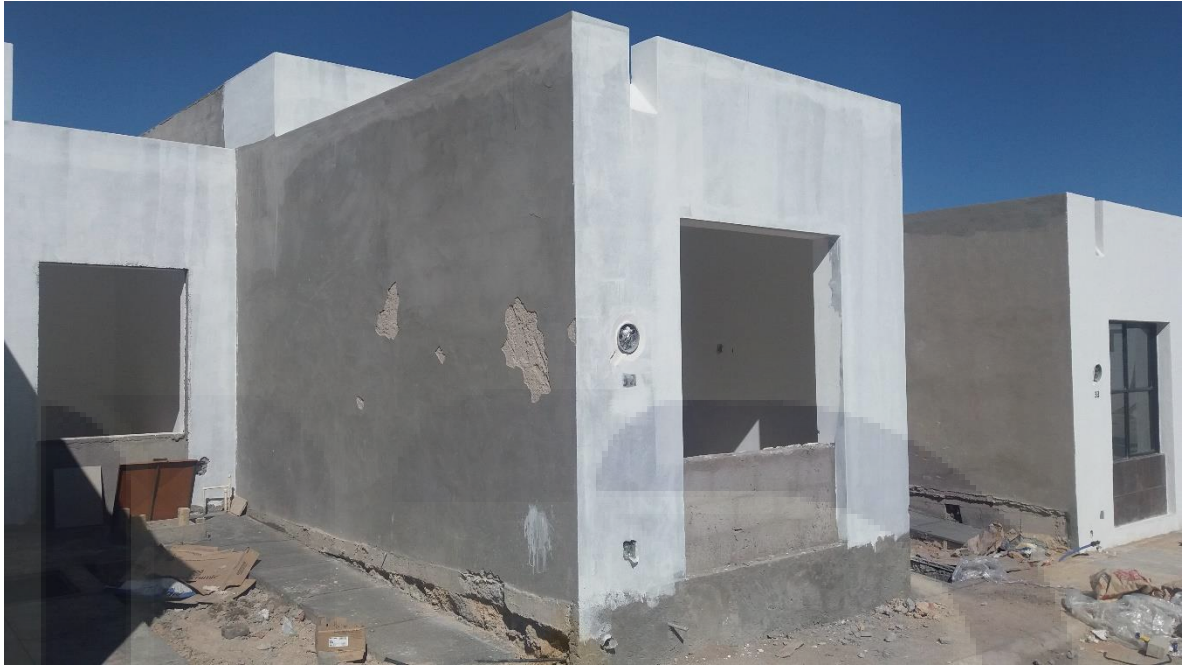
Imagen 9 Lesiones de abultamiento y desprendimiento de aplanado en paramento de vivienda en construcción, fraccionamiento San Gerardo, Aguascalientes.
