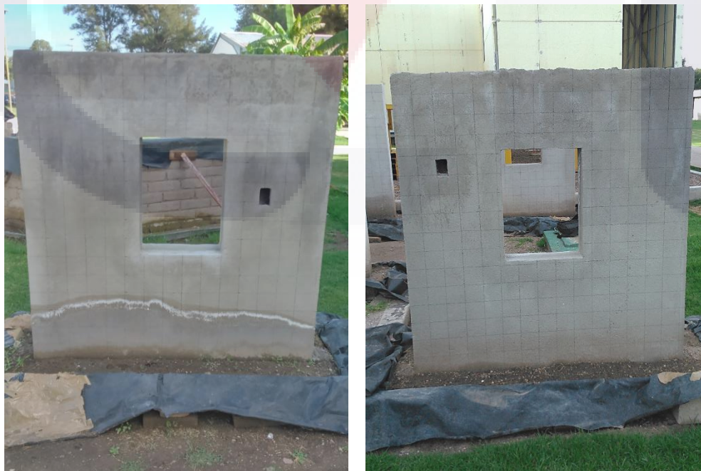
Imagen 52 Eflorescencias producidas por presencia de humedad en aplanados de muretes de prueba MBC 1-B-MCPA (Izq.) y MBC 1-B-MCEM (Der.).
