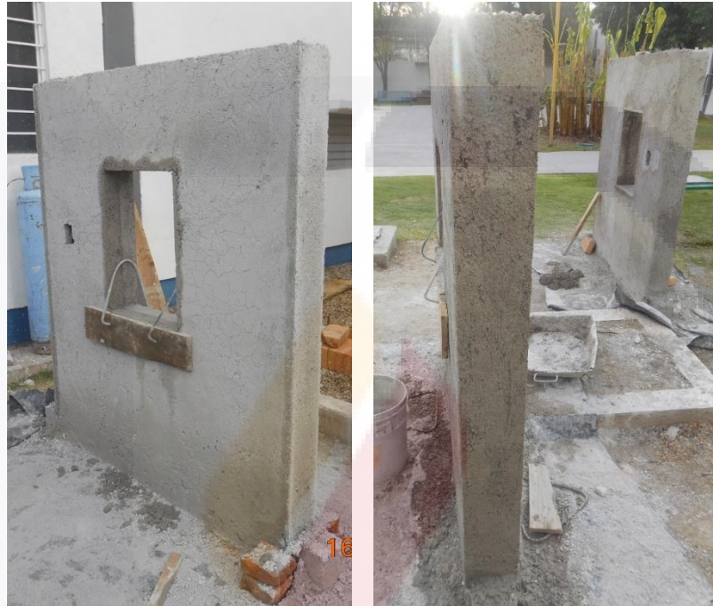
Imagen 35 (Izq.) Repellado en cantos interiores y exteriores de MBC 2. (Der.) Repellado en cantos de MTR 1 (adelante) y MBC 1 (atrás).
