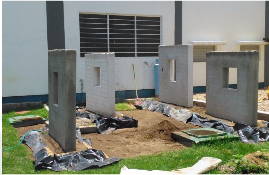
Imagen 49 Panorámica de los muretes con mecanismo para la retención de humedad recién habilitado.
