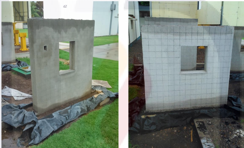
Imagen 50 Apariencia de los aplanados durante el registro de presencia de humedad.
