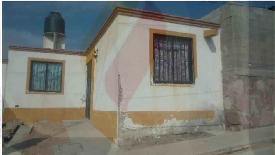
Imagen 3 Mampostería expuesta por deterioro y desprendimiento de aplanado en vivienda del fraccionamiento Villas de Nuestra Señora de la Asunción, Aguascalientes, Ags.
