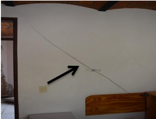
Muro planta baja eje D entre ejes 13 y 14
