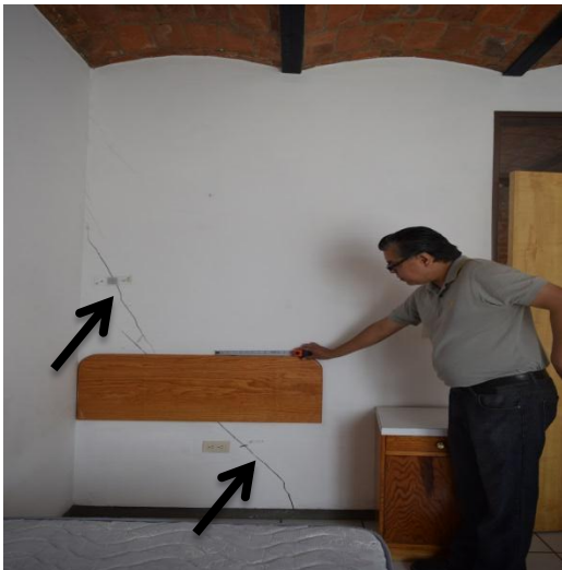
Muro planta baja eje D entre ejes 11 y 13
