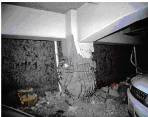
Foto No. 1 Edificio dañados por torsión sísmica, México 1985. (Trejo, J. 2007)
