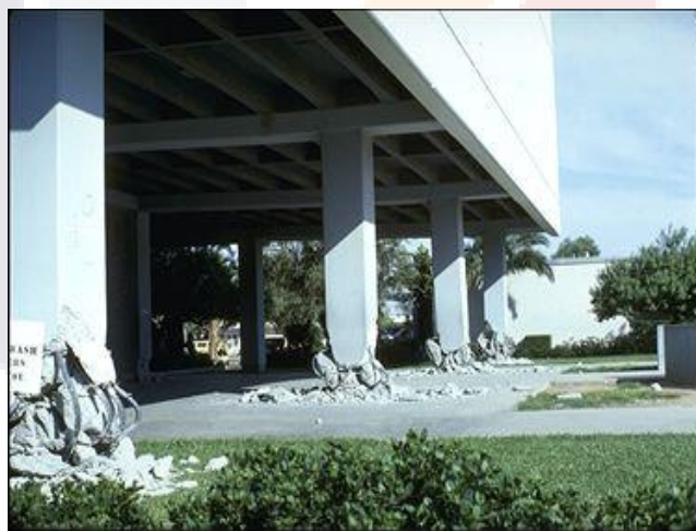
Foto No. 4 Daño en edificio por torsión (Escobar, J. A. et. all. 2007)
