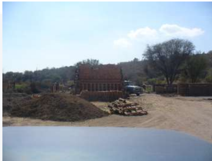
Figura 3.3 Horno de fabricación artesanal para el cocido de piezas de barro (Los Arquitos, Aguascalientes).
