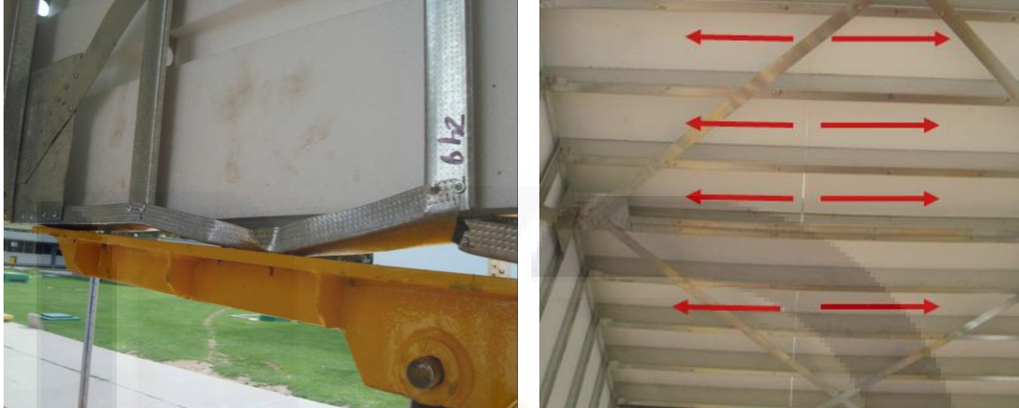
Figura 116.- Izquierda.-Desgarramiento de Track inferior y desprendimiento de tornillos de fijación. Derecha.- Asentamiento de 80 mm produce esfuerzos de tensión en azotea.
