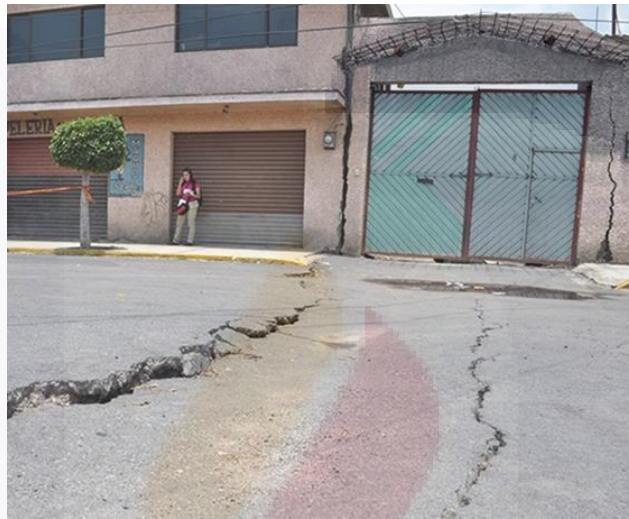
Figura 4.- Agrietamiento del suelo en Iztapalapa, Ciudad de México, causado por subsidencia. (puntogob.com)
