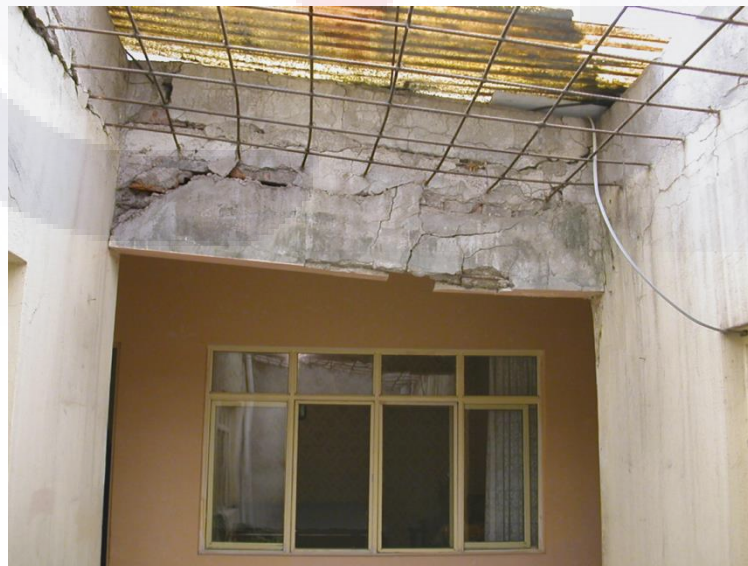
Figura 6.- Vivienda en la Ciudad de Aguascalientes dañada por asentamientos diferenciales.
