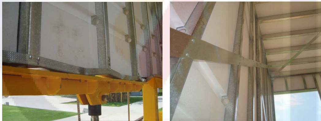
Figura 115.- Izquierda: Deformación excesiva en track inferior e inicios de rotura del mismo. Derecha: Parte posterior de vivienda con esfuerzos de tensión y compresión en contravientos
