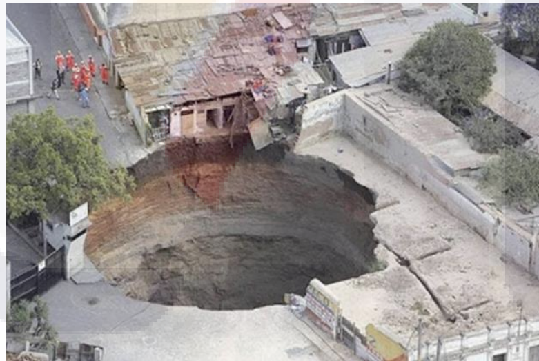
Figura 1.- Hundimiento de una gran porción de suelo causado por la disolución de materiales a profundidad (El Universal, 2007)
