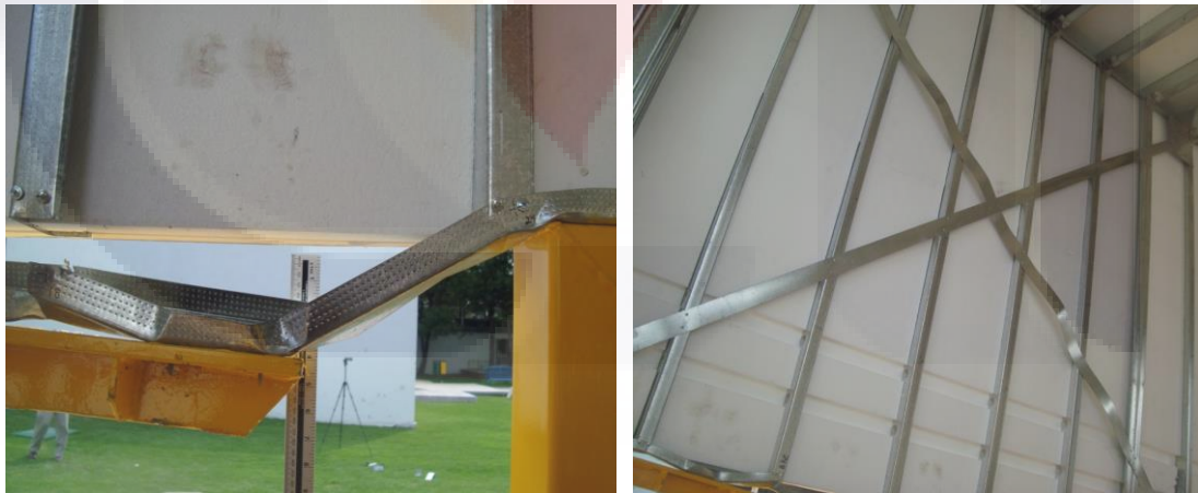
Figura 167.- Falla de track inferior por desgarramiento del patín y esfuerzos de tensión y compresión en diagonales de contraventeo.
