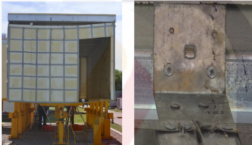
Figura 130.- Izquierda: Falla general del muro en la unión con el sistema de losa. Derecha: Detalle de la falla del ángulo de conexión muro-losa por esfuerzos cortantes en tornillos.
