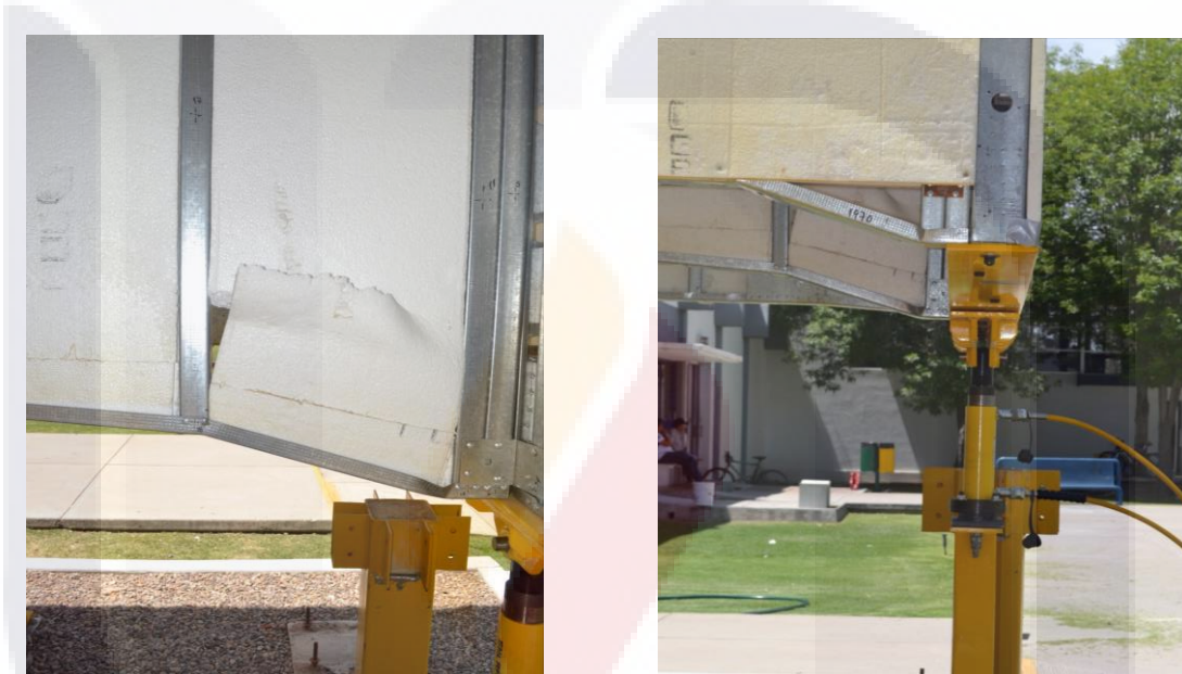
Figura 175.- Daños en tracks inferiores de los muros central y oriente.
