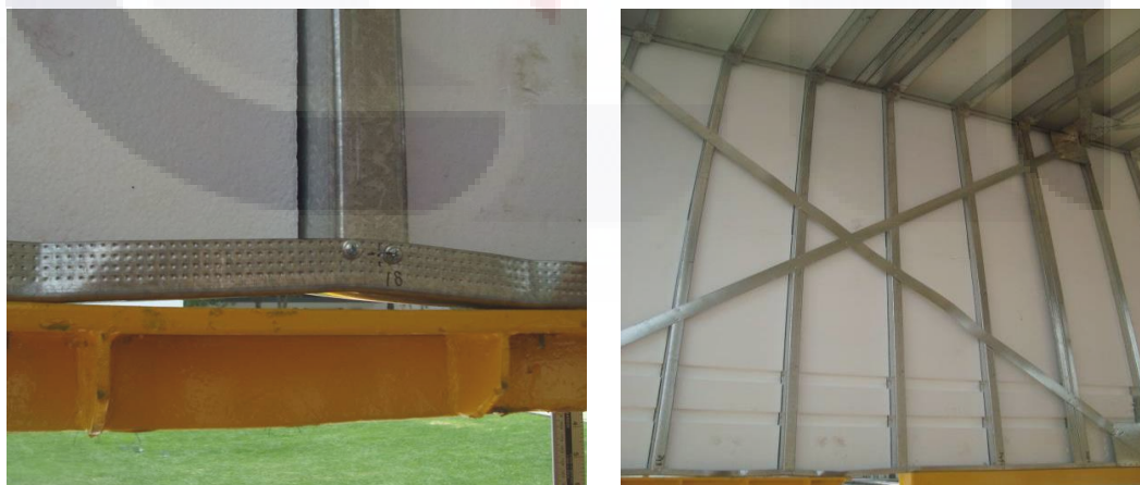
Figura 112.- Izquierda: Inicio de la deformación del track inferior en la viga de carga. Derecha: Deformaciones en contravientos por carga aplicada.
