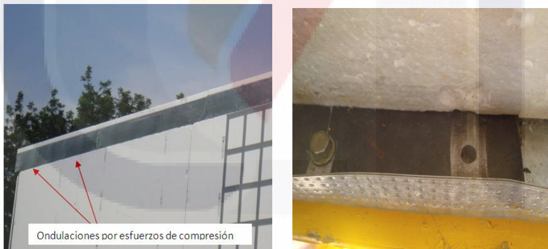
Figura 113.- Izquierda: Pandeo local por efectos de compresión en viga perimetral de losa. Derecha: Deformación de track inferior y falla del tornillo por esfuerzos de tensión.
