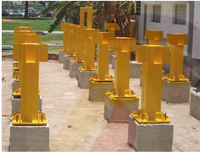
Figura 93.- Columnas de acero estructural para soporte de marcos.
