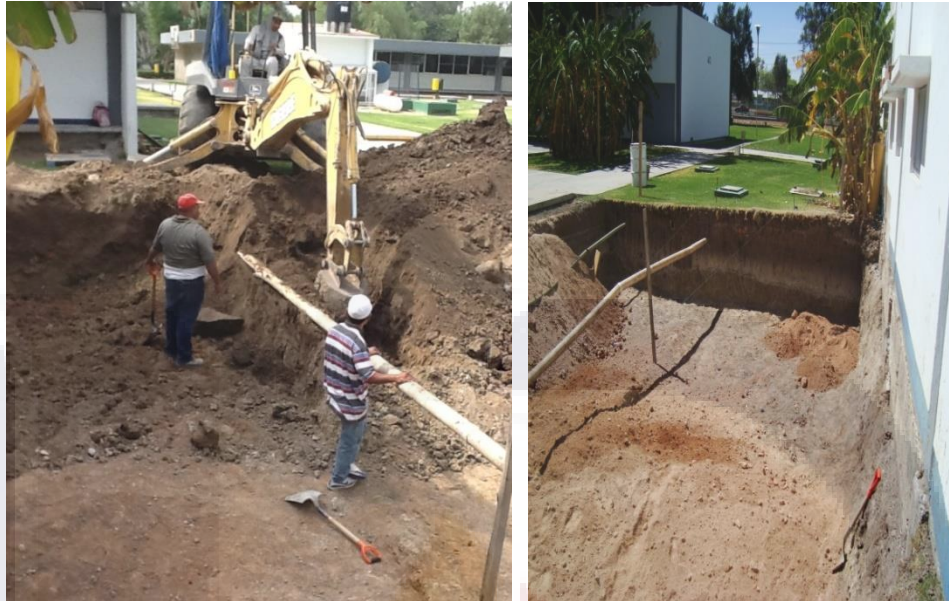
Figura 95.- Proceso de excavación para desplante de cimentación de la plataforma de simulación de hundimientos.
