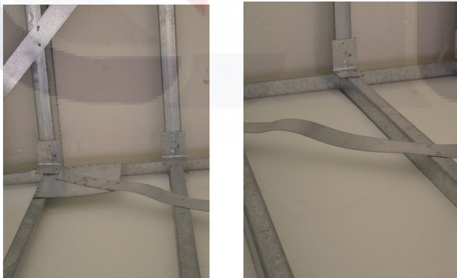
Figura 126.- Deformación excesiva en cerchas metálicas por esfuerzos de compresión.
