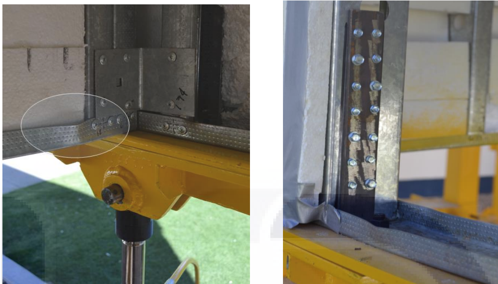
Figura 122.- Deformaciones en tracks inferiores cercanos al punto de desplazamiento
