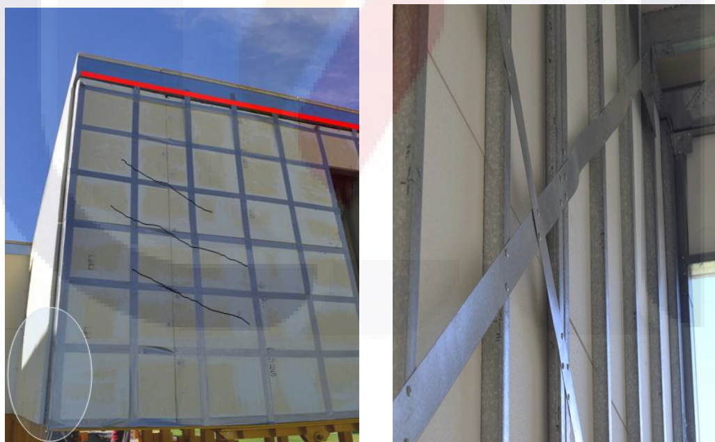
Figura 123.- Izquierda: Inicia separación del poliestireno en la parte superior e inferior del muro. Derecha: Contravientos en diagonal soportando esfuerzos de tensión y compresión.
