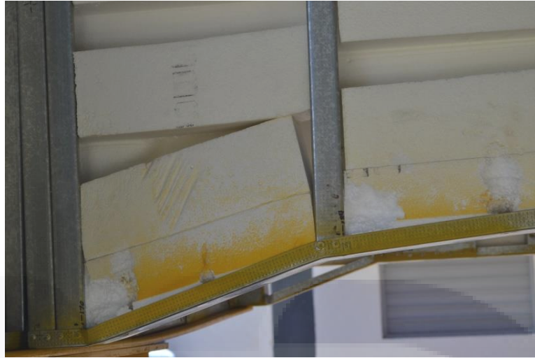
Figura 128.- “Escalonamientos” en muros que conectan con el muro de carga
