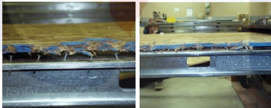
Figura 34.- Falla de los elementos de sujeción del panel OSB (Morgan, 2002).
