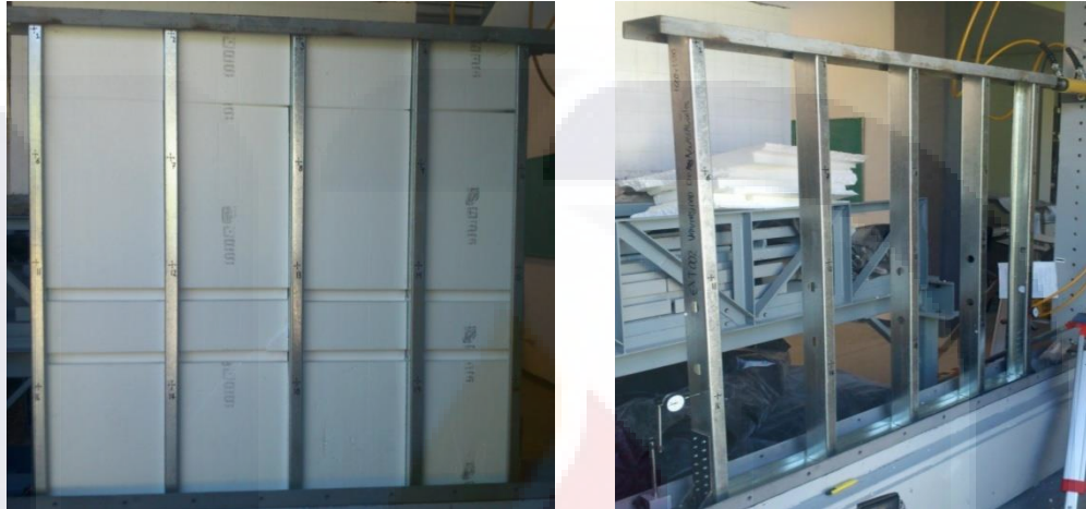
Figura 70.- Marco con recubrimiento de poliestireno y marco sin recubrimiento en la prueba a carga lateral
