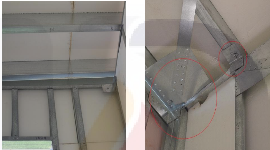
Figura 125.- Izquierda: Incremento de la separación del muro de carga en la conexión muro-losa. Derecha: Deformación del track superior y desplazamiento de clips conectores.
