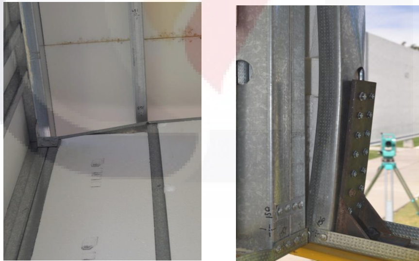
Figura 129.- Izquierda: Deformación del poliestireno y track en la parte superior de muro central. Derecha: Deformación en stud de muro lateral y separación de anclaje hold-down.
