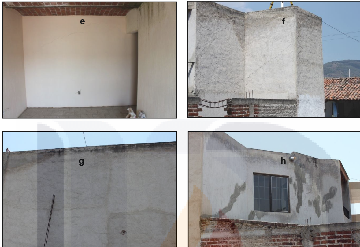
Fig. 5.10 Agrietamientos en muros planta alta (continuación): e) Transmisibilidad del asentamiento diferencial desde la planta baja, f) Continuidad del cortante hacia los muros posteriores, g) Cortante en muro colindante, h) Cortante en muros de fachada
