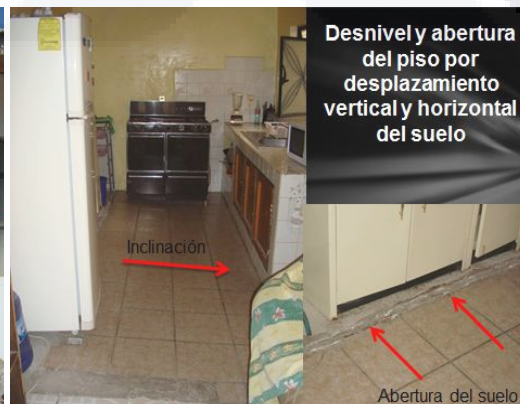
f) Daños en pisos
