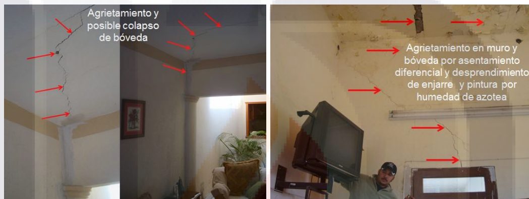
i) Daños en techos de viviendas
