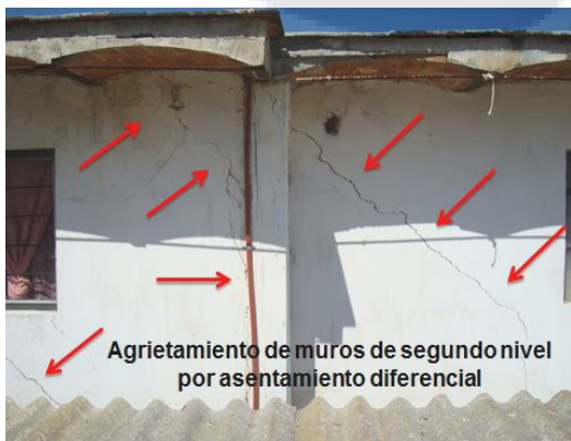
e) Daños en planta alta
