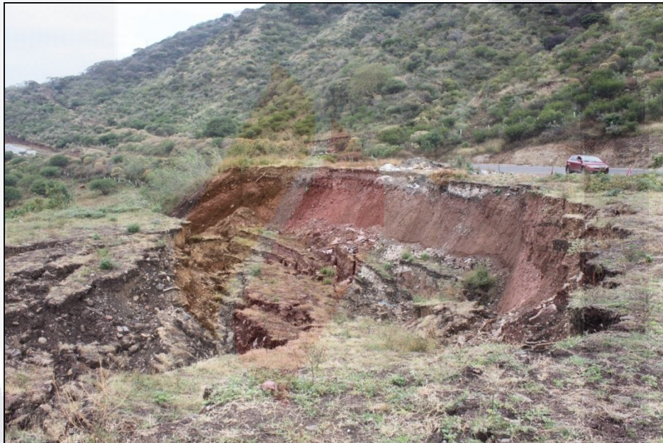
Figura 6.2 Colapso de taludes en libramiento por desvío de cauces de agua
