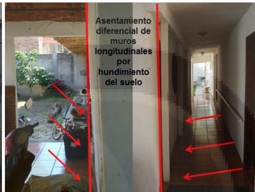
b) Asentamientos diferenciales
