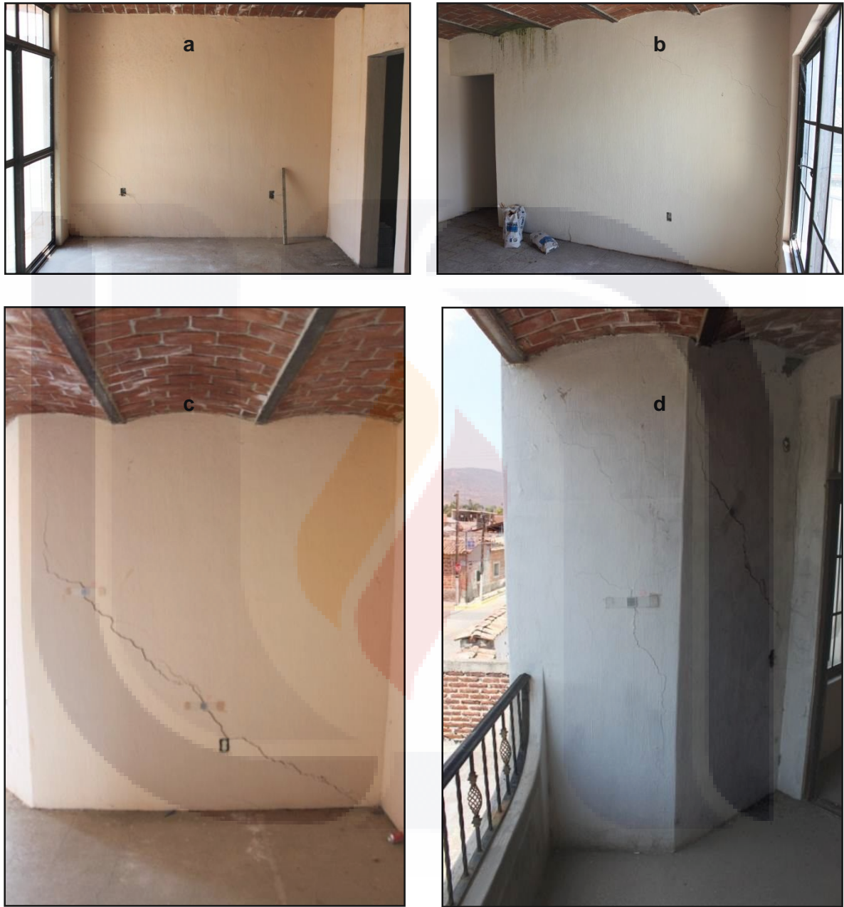
Fig. 5.10 Agrietamientos en muros planta alta: a) Transmisión de cortante desde bóveda de entresuelo, b) Desprendimiento de muro longitudinal y cortante hacia la bóveda, c) Asentamiento diferencial de los muros de fachada planta baja, d) Cortante en mochetas hacia la zona de hundimiento
