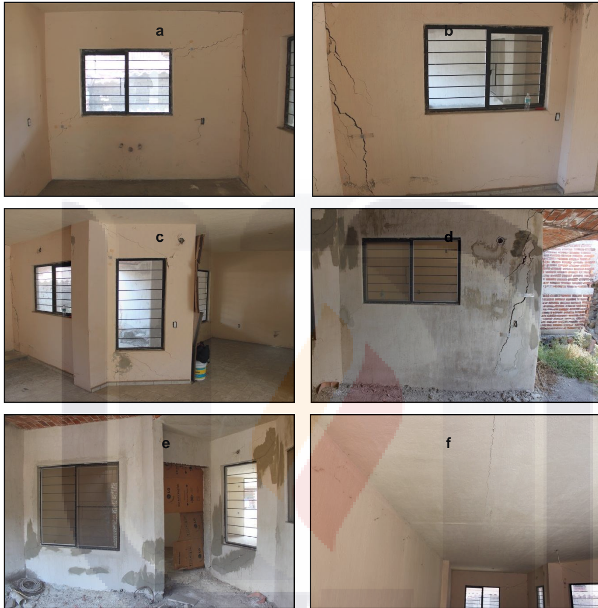
Fig. 5.9 Agrietamientos en muros de planta baja: a) Por flexión y cortante en muro de fachada, b) Desprendimiento de muro de fachada por asentamiento diferencial, c) Cortante en muro diagonal central, d) Asentamiento diferencial de muro de fachada, e) Cortante y flexión en muros de cochera, f) Desplazamientos de bóveda
