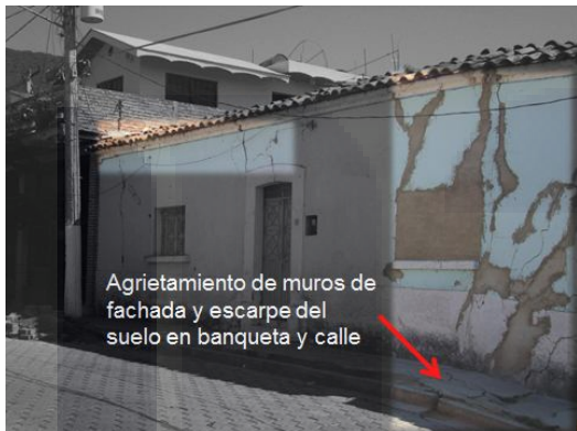
a) Daños en vialidades y fachadas
