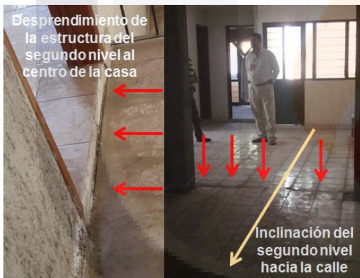
c) Desnivel en planta alta
