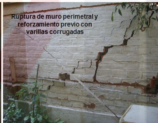
d) Daños en muros de lindero
