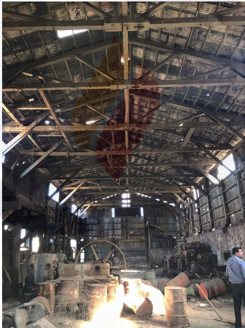
Imagen 13. Bodega denominada "El Salvaje" en las instalaciones de la Mina la Prieta en Parral, es un ejemplo de cómo muchos sitios de relevancia patrimonial se encuentran en riesgo. Autor: David Holguín Ojeda
