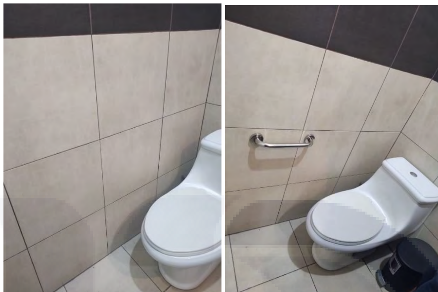
Ilustración 9 Baño Antes y Después de la Instalación de la Barra de Soporte
