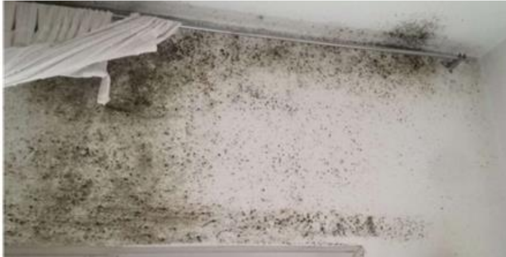
Figura 16: Presencia de humedad por condensación en cuarto de vivienda (Vega & Camargo, 2023).
