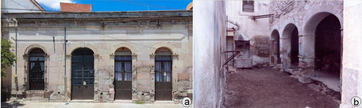
Figura 1: Casas con elevado deterioro en muros debido a la humedad. A) Casa el Rosal 102 de adobe y chapa de cantera. Imagen de Raudel Padilla Ceniceros. b) Imagen de Casa Terán obtenida en el año de 1991, zona de caballerizas, Aguascalientes. Imagen obtenida del archivo fotográfico del centro INAH Aguascalientes.
