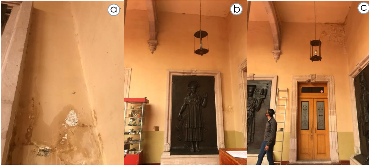
Figura 17: Presencia de humedad accidental en Museo Aguascalientes. A) humedad a metro y medio debido a tubería fracturada, B) localización de humedad en plafón y muro, C) humedad y patologías presentes en techo. Imágenes tomadas de informe técnico: "Estudio de bajadas pluviales del Museo de Aguascalientes"-ICA.
