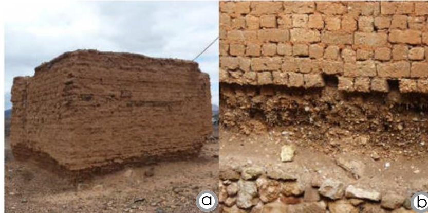
Figura 14: Pérdida de sección en el arranque de un muro de adobe por ascensión de humedad capilar: 1a. Muro de adobe carente de cimentación en Fuerteventura, Las Palmas. 1b. Muro de adobe con cimentación de mampostería en Poza de la Sal, Burgos (Mileto & López Manzanares, s/f).
