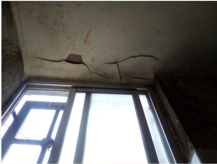
Ilustración 16 Presencia de agrietamiento en el recubrimiento, causado por la humedad ocasionada por la fuga de calentador solar. Imagen del autor.
