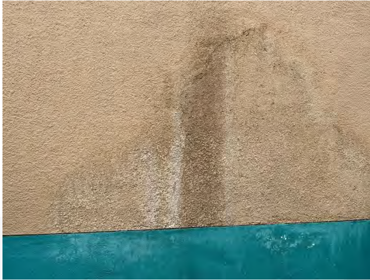
Ilustración 7 Humedad ascendente visible en el recubrimiento del muro. Imagen del autor.
