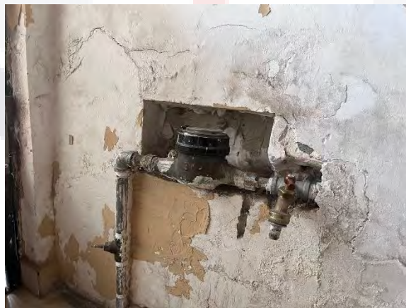
Ilustración 9 Efecto de la humedad ocasionada por toma de agua cercana. Imagen del autor.
