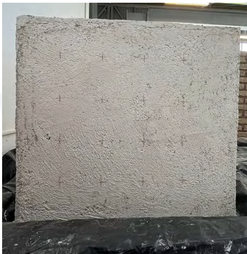
Ilustración 48 Muro 4, Lado B. Imagen del autor.
