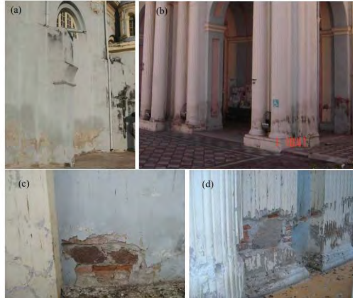
Ilustración 2 “En la fachada del atrio se observa en la actualidad algún deterioro en la pintura, Figura 2. a) y b) muestra humedad en muros de la fachada; c) y d) deterioro de columnas y mampostería por el proceso de humedecimiento y secado.” (Gea et al., 2014)
