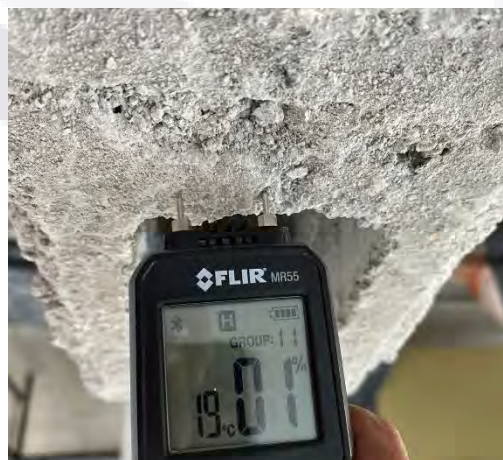
Ilustración 38 Medida de contenido de humedad del Block de concreto hueco con el FLIR MR55. Imagen del autor.
