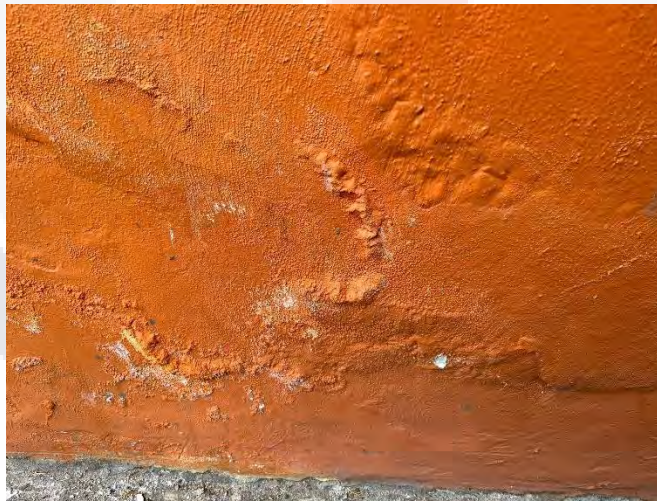
Ilustración 6 Efecto "película" en un muro de ladrillo, causado por la filtración de humedad. Imagen del autor.
