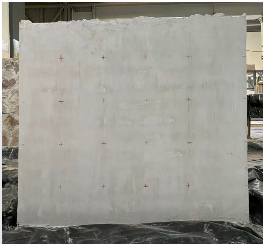
Ilustración 46 Muro 3, Lado B. Imagen del autor.
