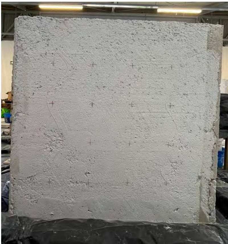
Ilustración 44 Muro 2, Lado B. Imagen del autor.
