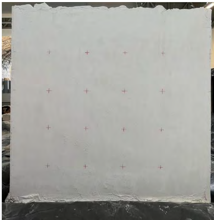
Ilustración 42 Muro 1, Lado B. Imagen del autor.
