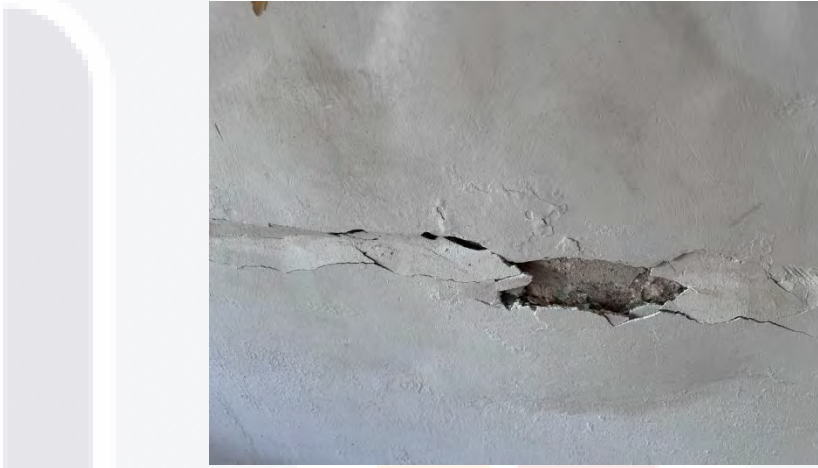
Ilustración 12 Ampollas generadas por la posible fuga interna de una tubería, esto es deducible dada la localización de salidas de agua, así como el recorrido lineal de la humedad. Imagen del autor.
