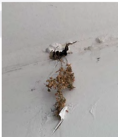
Ilustración 17 Crecimiento de plantas en orificio ocasionado por la infiltración de humedad en la parte superior del muro. Imagen del autor.
