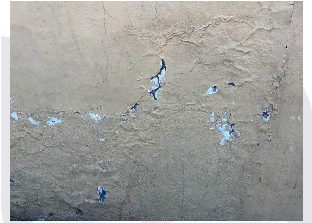
Ilustración 15 Distintos tipos de deterioros ocasionados por la humedad, entre los que destacan, el agrietamiento, películas y la más común, la descamación, producto de la humedad por filtración, dado el comportamiento de la humedad. Imagen del autor.
