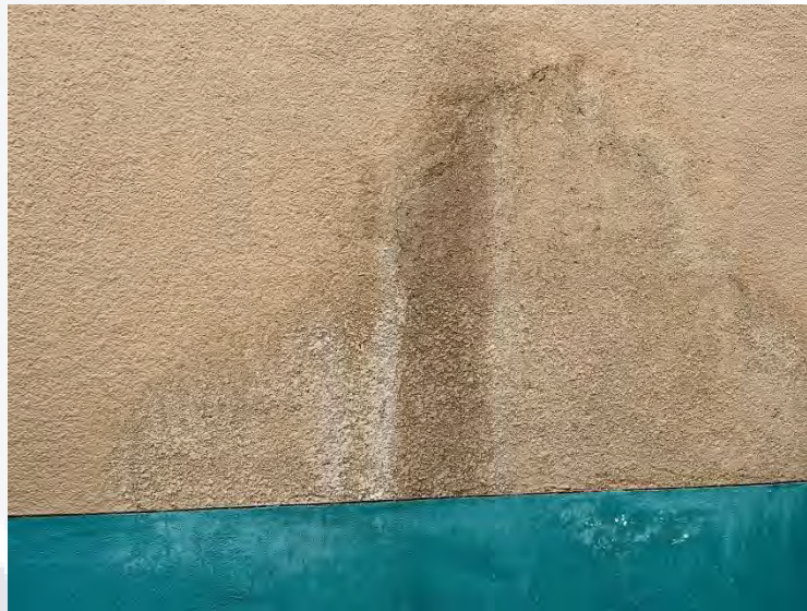
Ilustración 14 Humedad ascendente visible en el recubrimiento del muro. Imagen del autor.
