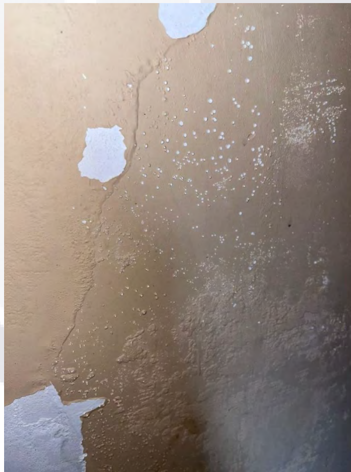
Ilustración 8 "Pitting" observado en un muro con recubrimiento de yeso, ocasionado por la humedad por condensación. Imagen del autor.
