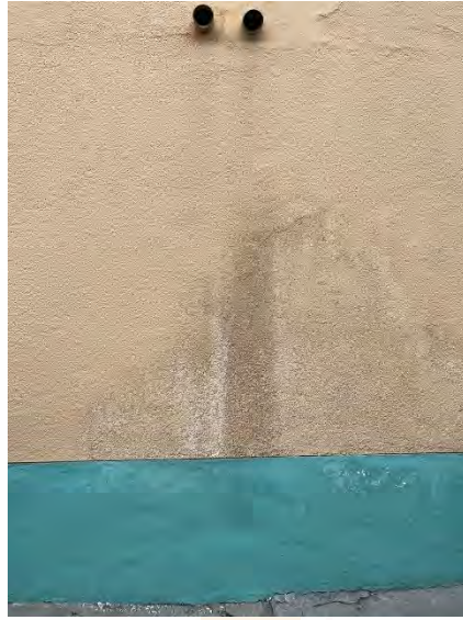
Ilustración 10 Humedad ocasionada por descarga pluvial. Imagen del autor.
