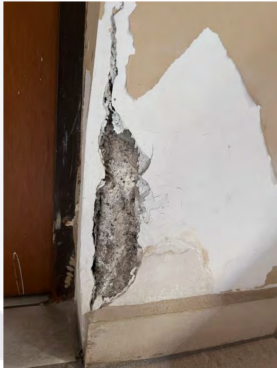
Ilustración 13 Estallido en una esquina posiblemente debido a la corrosión del armado del castillo, ocasionada por la humedad de infiltración proveniente de un baño al otro lado del muro. Imagen del autor.
