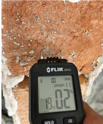
Ilustración 39 Medida de contenido de humedad del Ladrillo rojo recocido con el FLIR MR55. Imagen del autor.
