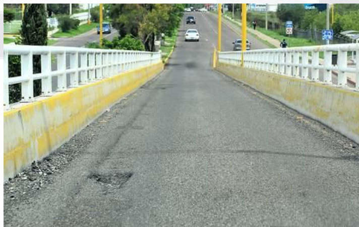
Ilustración 7 Ejemplo de un defecto funcional en puentes. Imagen del autor
