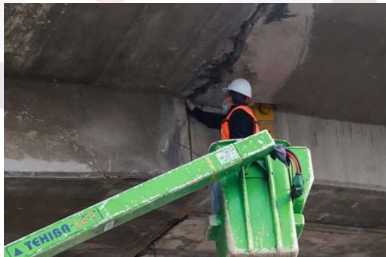
Ilustración 8 Ejemplo de un defecto estructural en el puente México en AGS (El puente de Segundo Anillo en la Colonia México no tiene daños, ni implica riesgos, s/f)
