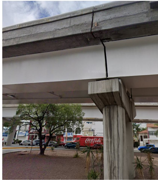
Ilustración 29 Junta constructiva realizada en el cuerpo sur que aísla a los claros 4 y 5. Imagen del autor.
