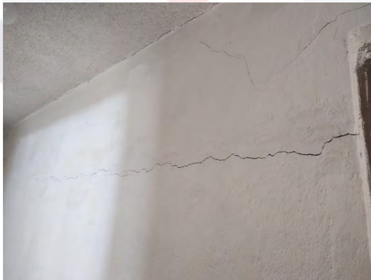
Figura 3. 14 Grieta de lado a lado indicando probable deslizamiento (Fuente propia).
