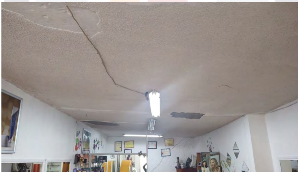
Figura 3. 6 Daño en techo de la vivienda (Fuente propia).
