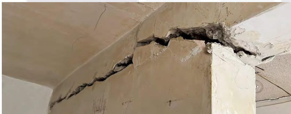
Figura 3. 12 Daño más fuerte en muro de la vivienda (Fuente propia).
