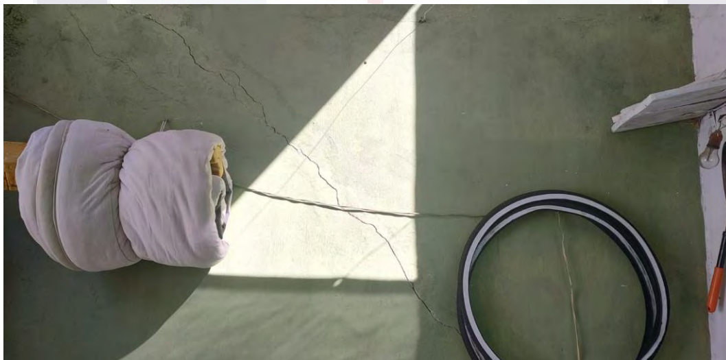
Figura 3. 9 Otro muro con grieta en diagonal (Fuente propia).
