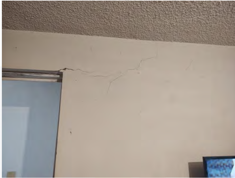
Figura 3. 13 Pequeña grieta en la parte alta del muro (Fuente propia).
