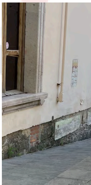
Figura 51. Muro exterior en primer patio. Fuente: Elaboración propia. Fecha: 2022
