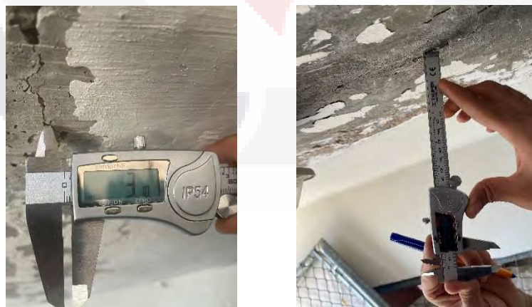
Figura 5.22. Mediciones realizadas en elementos dañados de la bodega dos
