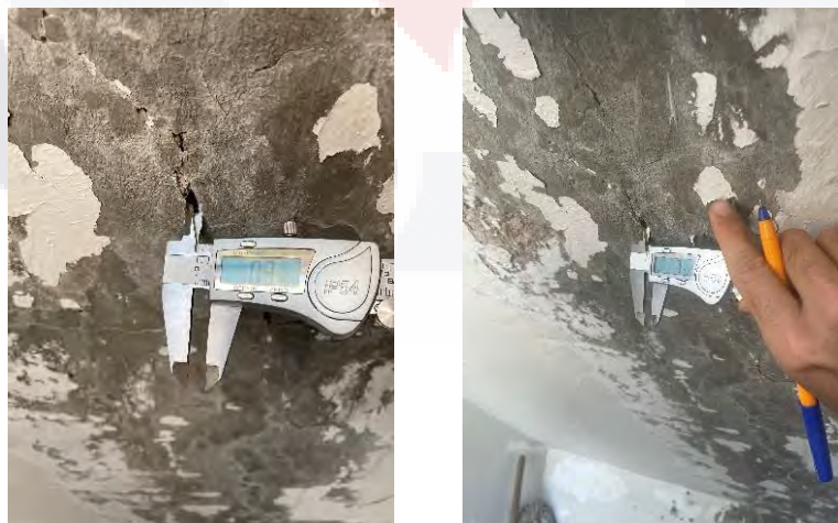
Figura 5.24. Mediciones realizadas en elementos dañados de la bodega cinco
