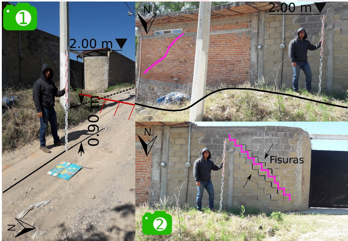
Figura 5.8 Imágenes del sitio 2, la ubicación de las imágenes se observa en la Figura 5.7. 1) Escarpe de 0.90 metros con un buzamiento hacia el oriente. 2) Daños en las construcciones cercanas a la falla.
