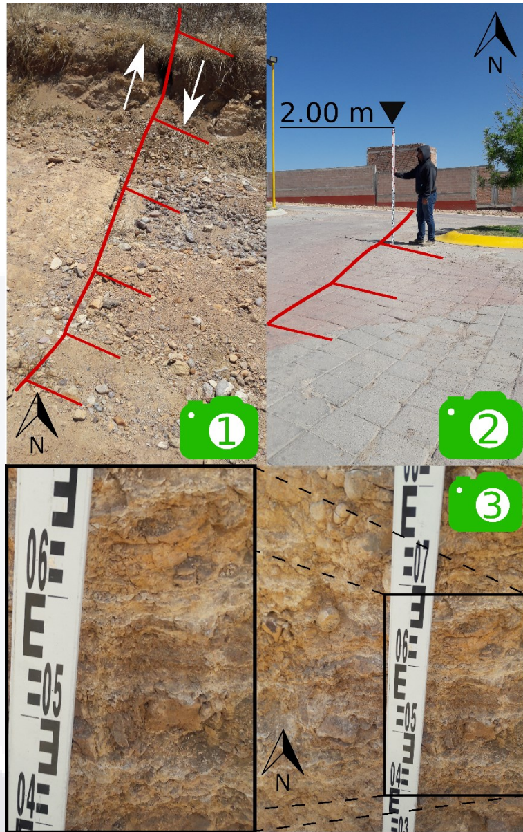
Figura 5.14 Imágenes del sitio 3, la ubicación de las imágenes se muestra en la Figura 5.13. 1) Muestra una grieta en el suelo 2) daños en la infraestructura 3) Estratos rellenos con caliche.
