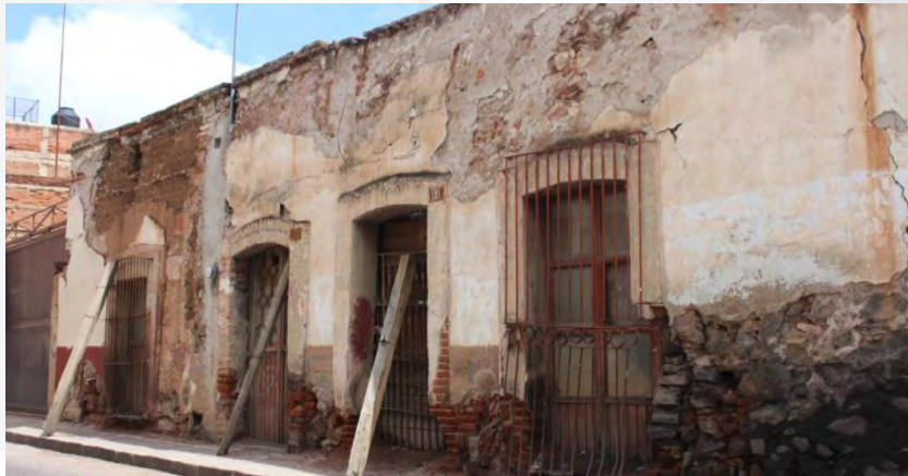
Imagen 4 edificación apuntalada en peligro de derrumbe
