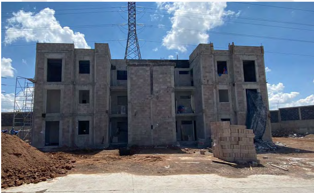
Figura 22 Estado de la torre de departamento al inicio de la estancia profesional
