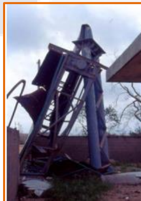
Imagen 9, fallas en conexiones pedestal-panel. Fuente Artículo de Divulgación Baeza J. et. al. / Ingeniería 8-3 (2004)
