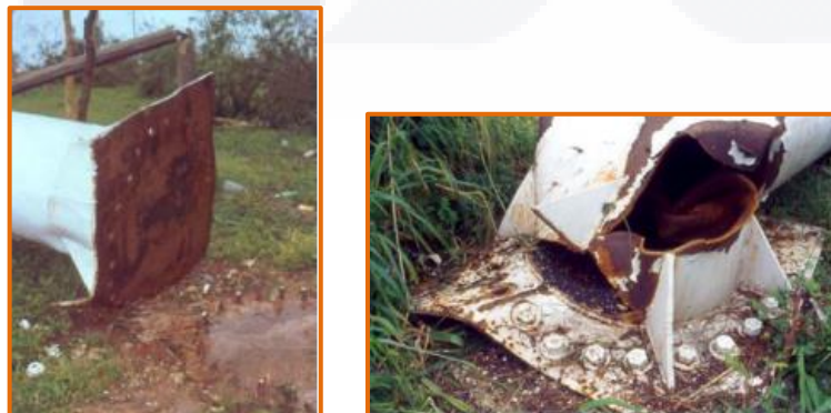
Imágenes 12 y 13, fallas en conexiones pedestal-placa-base. Fuente Artículo de Divulgación Baeza J. et. al. / Ingeniería 8-3 (2004)
