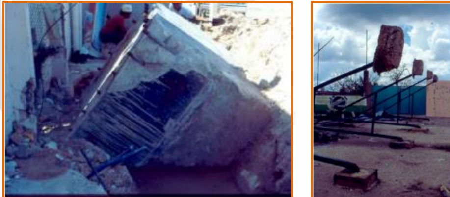
Imagen 16 y 17, fallas del suelo de la cimentación. Fuente Artículo de Divulgación Baeza J. et. al. / Ingeniería 8-3 (2004)
