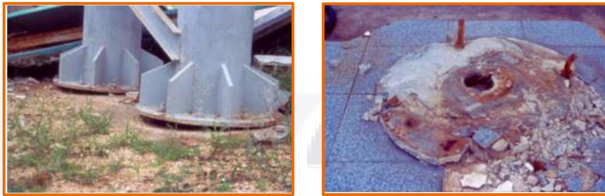
Imagen 14 y 15, fallas en anclas-base-zapata. Fuente Artículo de Divulgación Baeza J. et. al. / Ingeniería 8-3 (2004)
