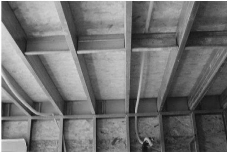
Ilustración 15 Vista de la estructura del entrepiso con vigas de perfiles galvanizados, fuente: STEEL FRAMING ARQUITECTURA, ILAFA
