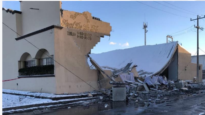
Fig. 3.2.1b. Colapso parcial de salón de eventos por acumulación de nieve en cubierta (Saltillo, México 2017)
