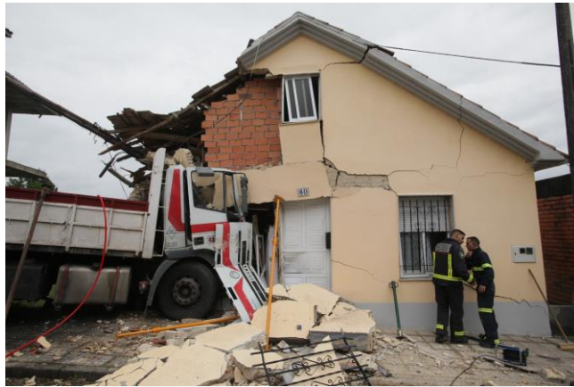
Fig. 3.2.1a. Colapso parcial de casa habitación por impacto accidental de vehículo (Galicia, España 2016)
