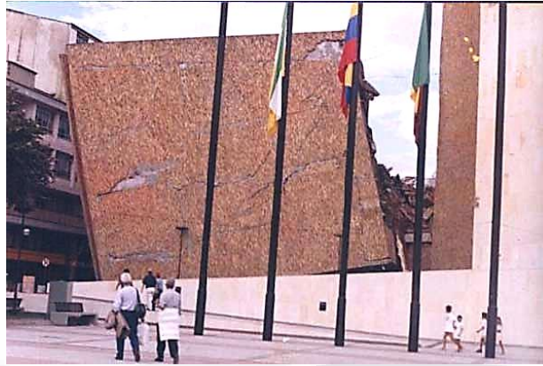
Figura 3.1.1j. Imagen del colapso del anexo de edificio de gobernación de Quindío, Colombia, tras el sismo presentado en 1999.
