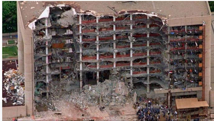
Fig. 3.2.1d. Colapso parcial de edificio Alfred P. Murrah por atentado terrorista (Oklahoma, E.U. 1995)
