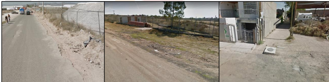
Imagen 9. Estado físico de la carretera No. 69 en tramo Los Arellano
