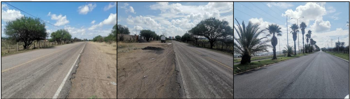
Imagen 8. Estado físico de carreteras 61 y 2 (Blvd. Aeropuerto), respectivamente.
