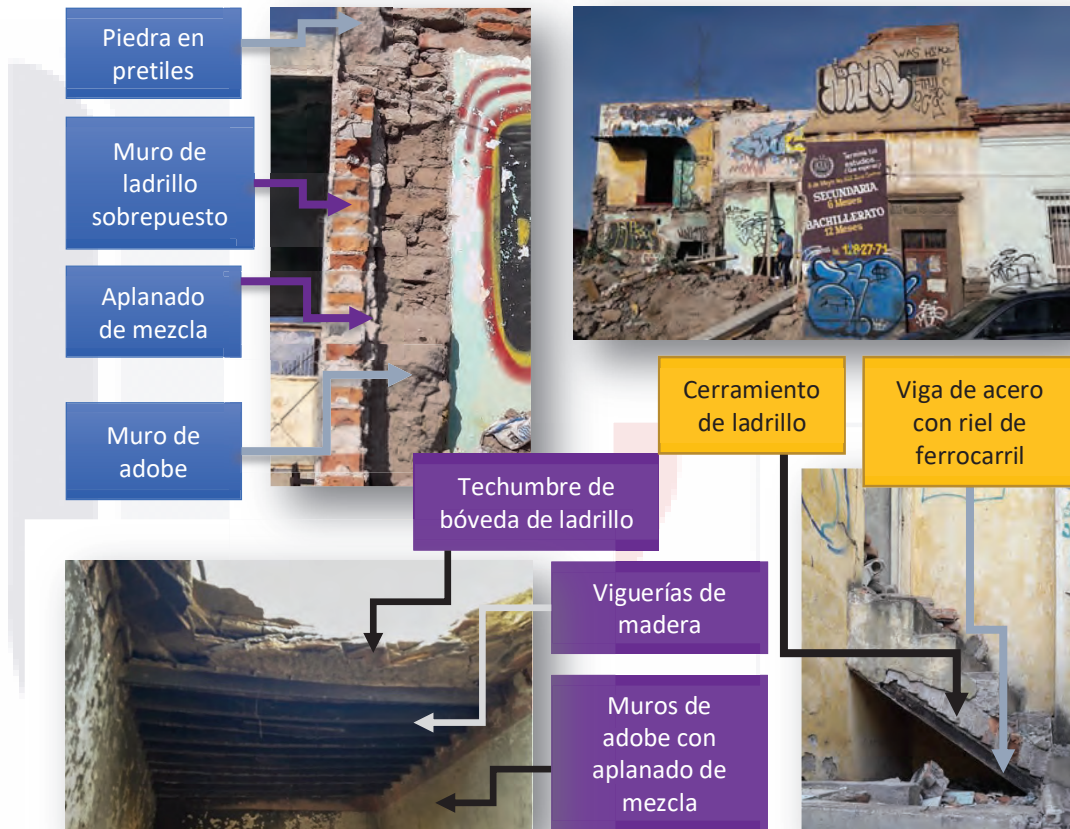
Imagen 7.5 fotografías de casa en ruinas donde se puede observar los materiales y sistemas constructivos. Obsérvese la presencia de rieles de ferrocarril como vigas en estructuras
