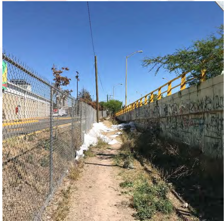
Figura 7. Fotografía demostrando inseguridad y deterioro en paso a desnivel
