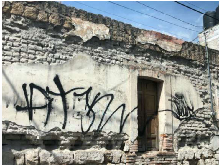
Imagen 19 Deterioro de viviendas en la zona centro
