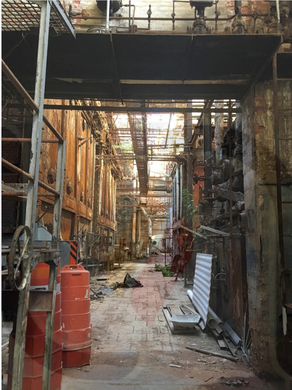
Ilustración 88: La casa de energía en 2017, por falta de mantenimiento tiene un importante estado de deterioro en elementos de cubrición lo cual amenaza otros elementos interiores. Fuente: José Humberto Flores Castro.
