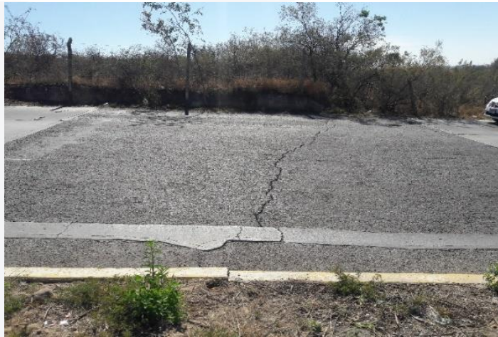
Figura 5. Ejemplo de una vialidad dañada al sur de la ciudad de Aguascalientes, debido a los efectos del hundimiento diferencial.
