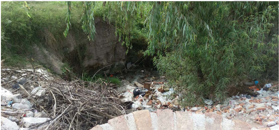
Imagen 18.- Tiradero de basura vertido en el cauce del Río Chicalote junto a una cámara de inspección sanitaria. Fuente: galería fotográfica de VERTIQAL.
